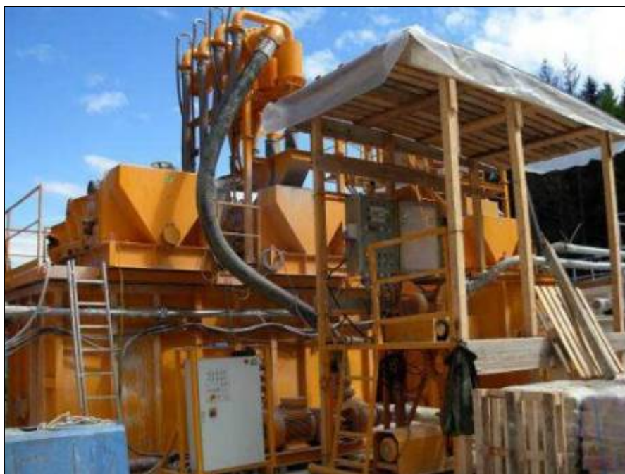
Fig. 2.13/C – Sistema di disidratazione
