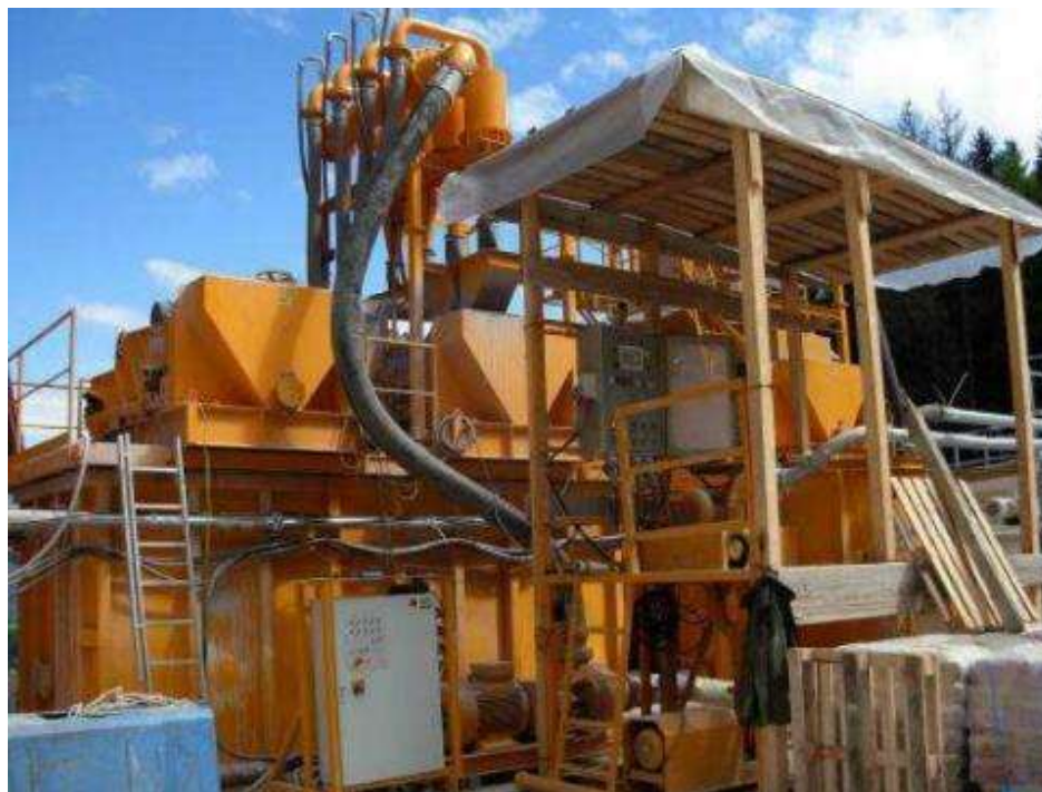
Figura 2-26 – Sistema di disidratazione
