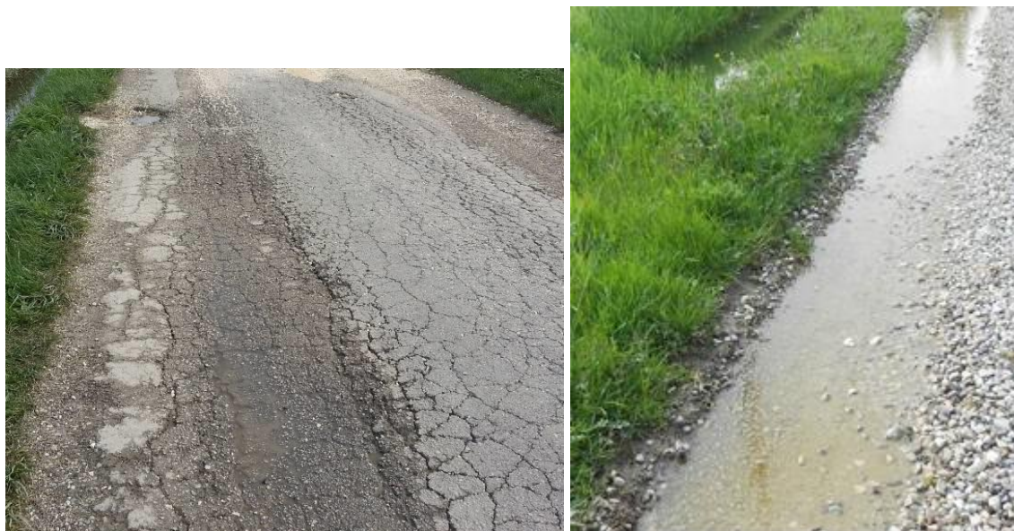
FIGURA 4-35 – A) FESSURAZIONI ALL'INTERNO DELLO STRATO DI USURA; B) PRESENZA DI ACQUA AI LATI DEGLI STRADELLI
