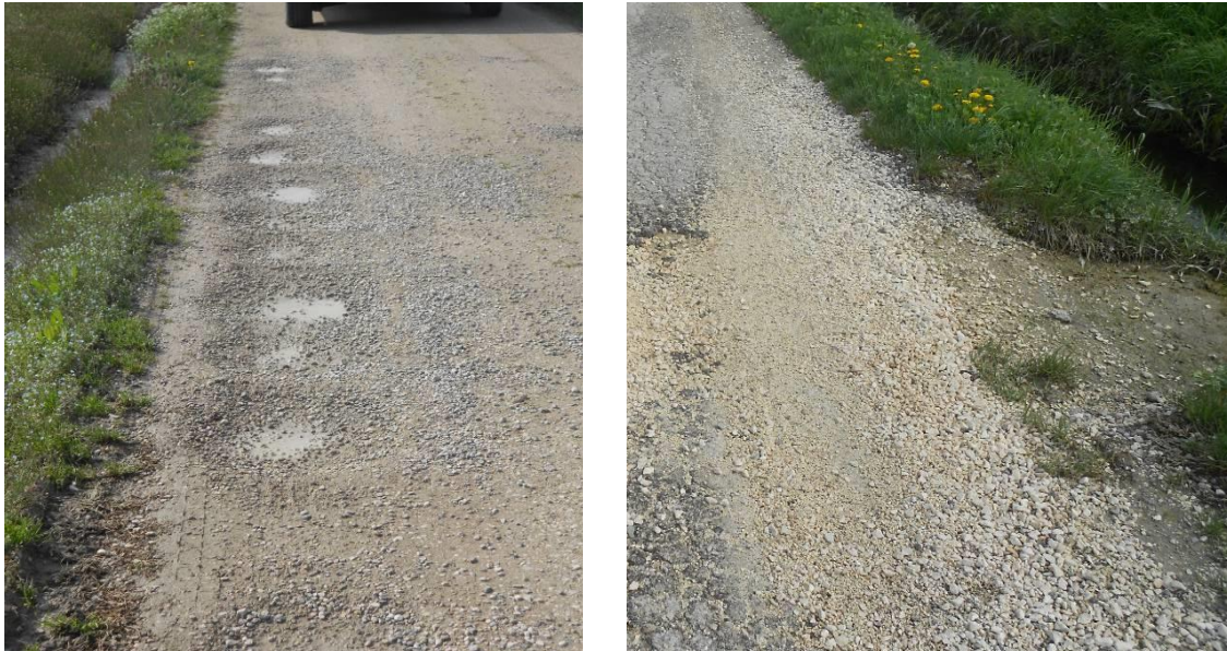
FIGURA 4-34– A) PRESENZA DI BUCHE RISCONTRATORE NEL CORSO DEL SOPRALLUOGO PRELIMINARE; B) FORTE PENDENZA DEGLI STRADELLI IN DIREZIONE DEI FOSSI LATERALI
