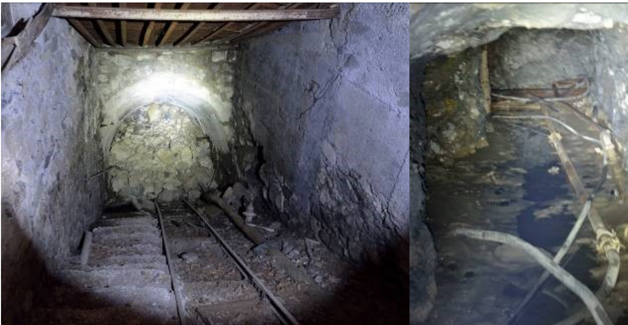
Figura 1 A sinistra, galleria con ingresso ostruito da detriti. A destra, galleria loc. Malanotte.
