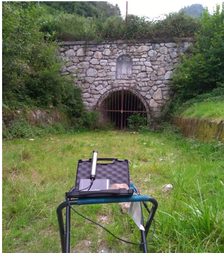
Figura 14 Monitoraggio acustico nei pressi del portale Ponente con evidente struttura e tipologia del muro con fessure.
