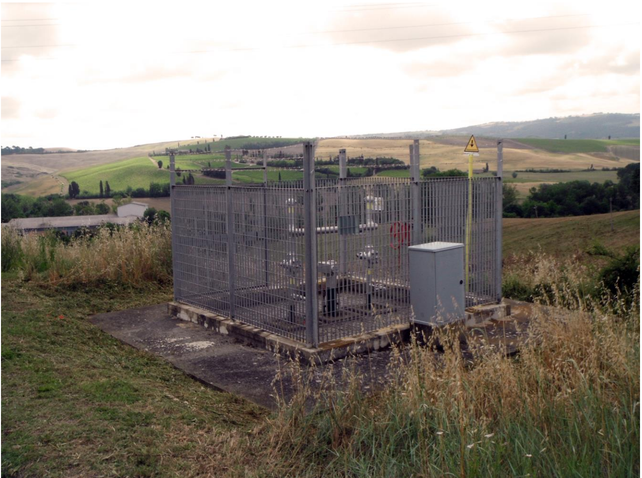
Fig. 5.4 – Stato attuale del PIL 4103653/9 in rimozione.
