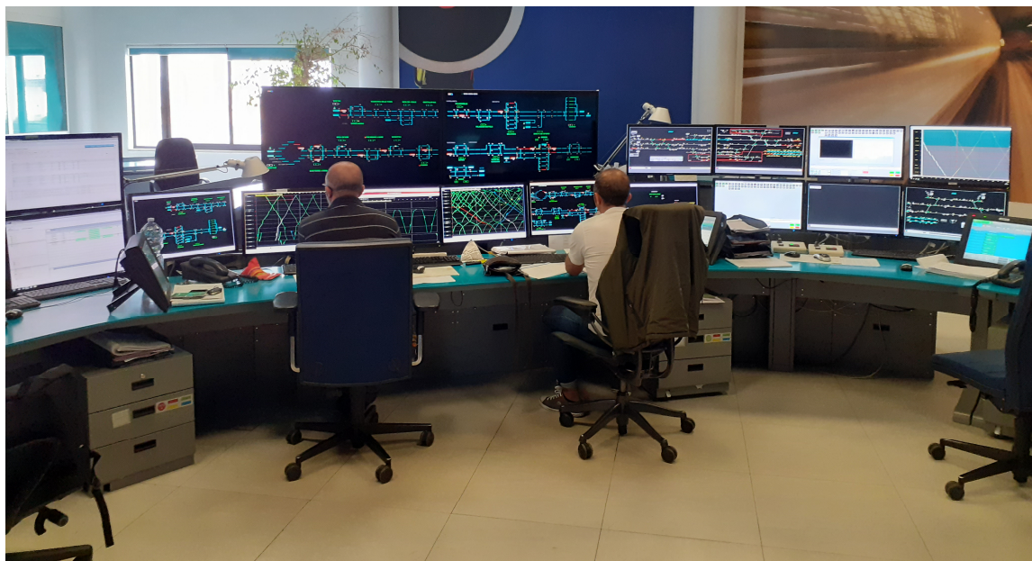
Figura 7 – Postazione Operatore DCO Bari C.le - Lecce
