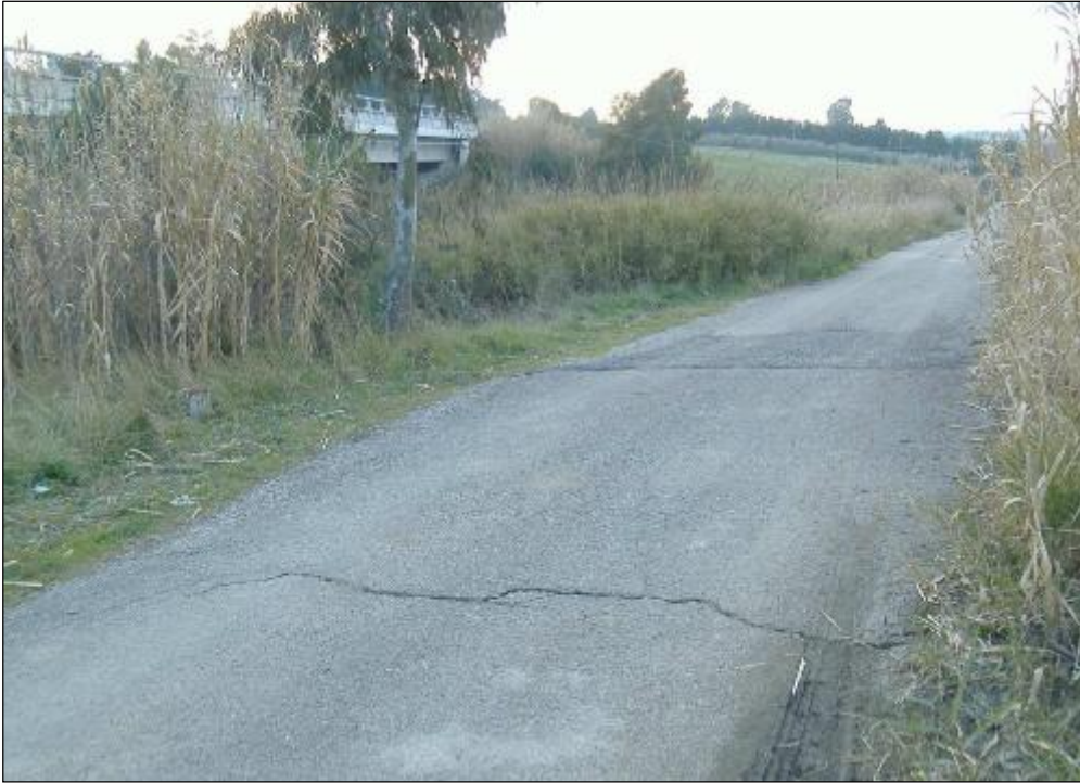
Figura 8-39 Frattura nella pavimentazione stradale sulla strada vicinale nel tratto compreso tra il viadotto Cacchione e la Ferrovia (F.20).
