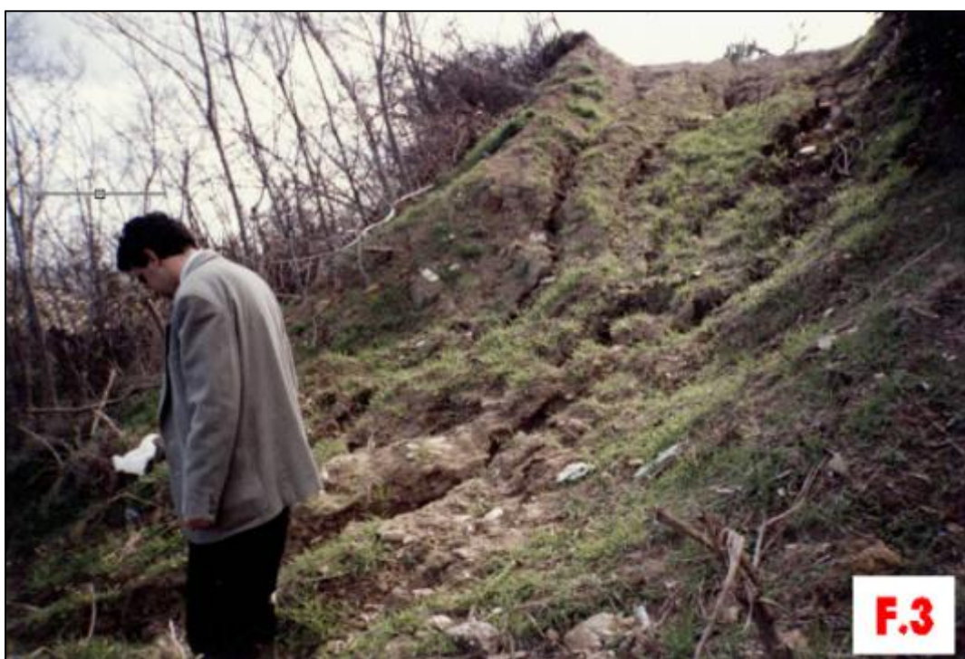
Figura 8-4 Lesione in zona di coronamento, porzione orientale (foto del 7 febbraio c.a.).
