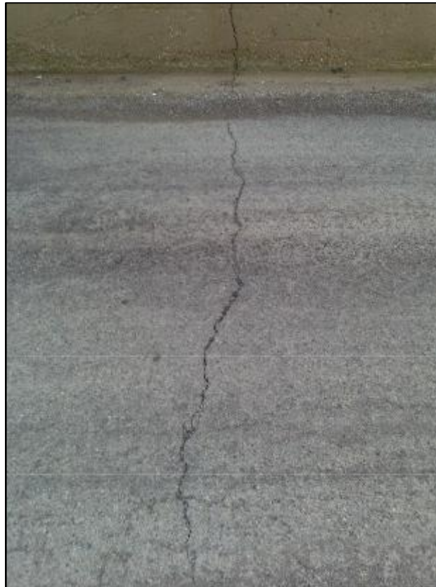
Figura 8-47 Località "Torre di Petacciato" Lesioni sulla pavimentazione della strada comunale in adiacenza alla ferrovia (F.28).
