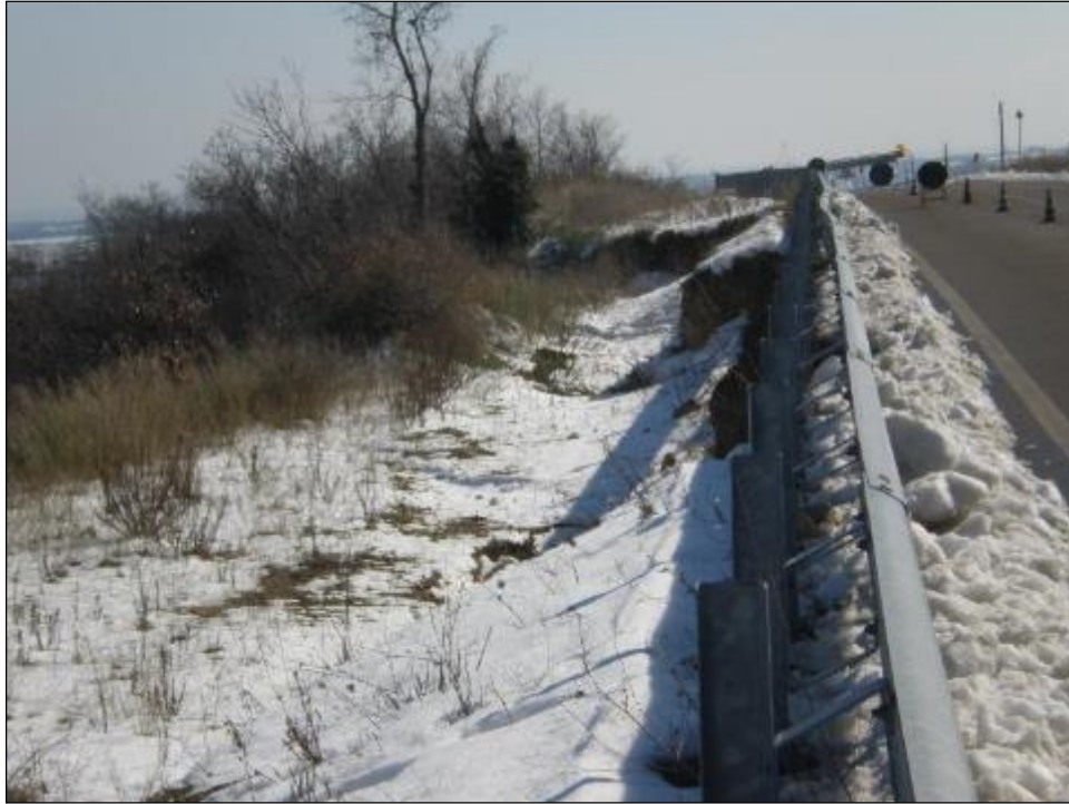
Figura 8-27 Località "Vaccareccia" – Lesioni lungo la strada provinciale di Petacciato (F8).
