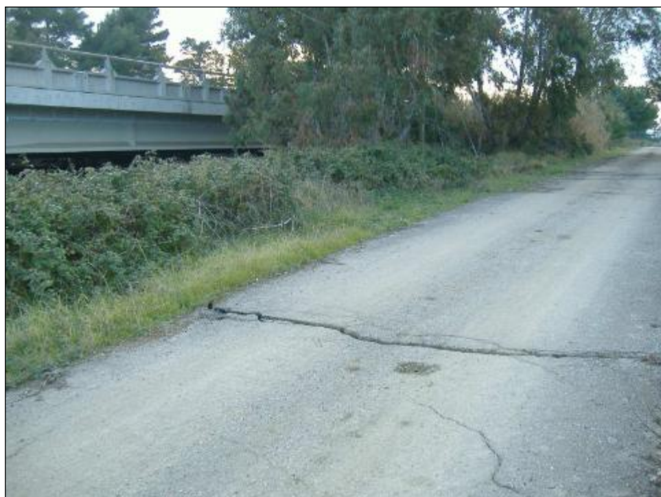
Figura 8-38 Frattura nella pavimentazione stradale sulla strada vicinale nel tratto compreso tra il viadotto Cacchione e la Ferrovia (F.19).
