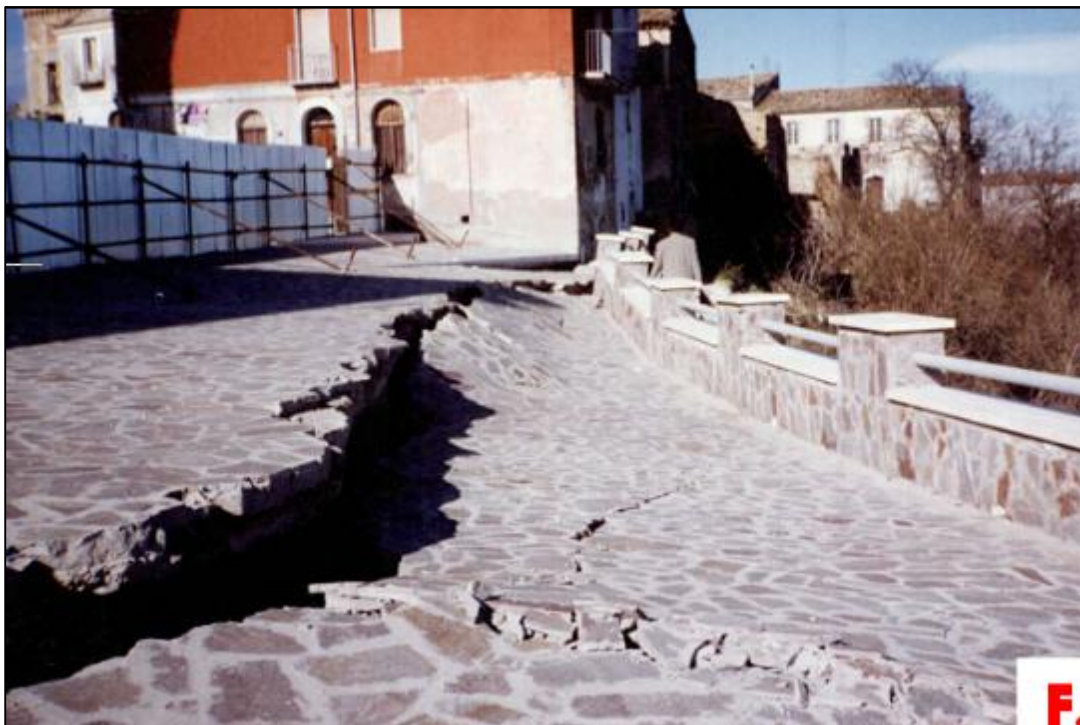
Figura 8-2. Lesione in zona di coronamento (foto del 7 febbraio c.a.)
