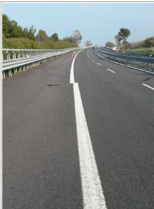
(44) Lesione S5 - Vista disassamento linea di margine
