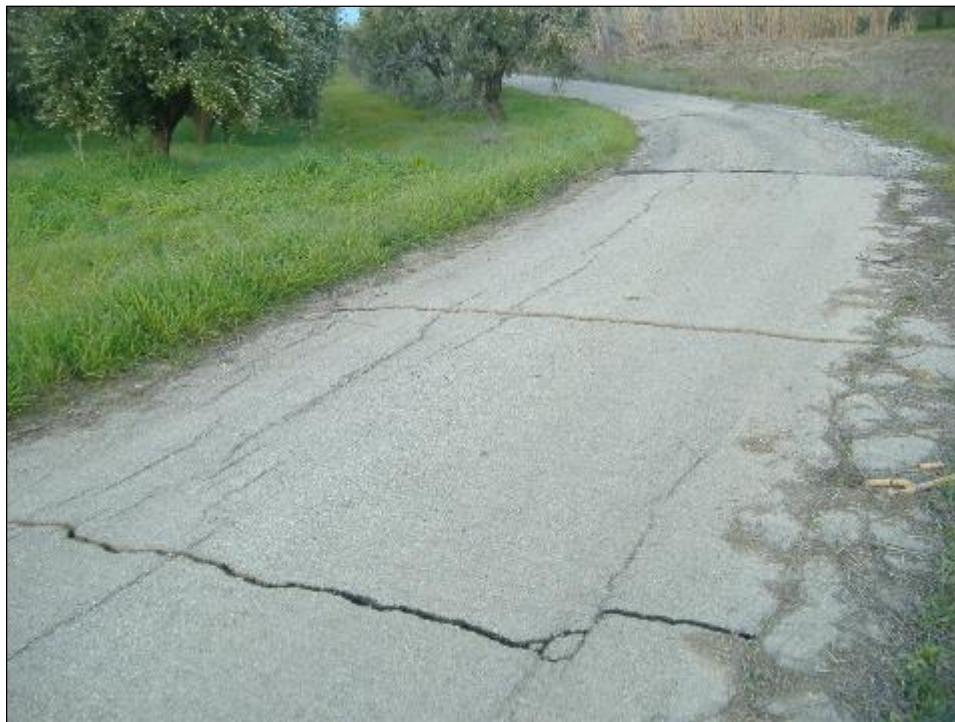
Figura 8-37 Frattura nella pavimentazione stradale della strada comunale che scende a mare (F.18).
