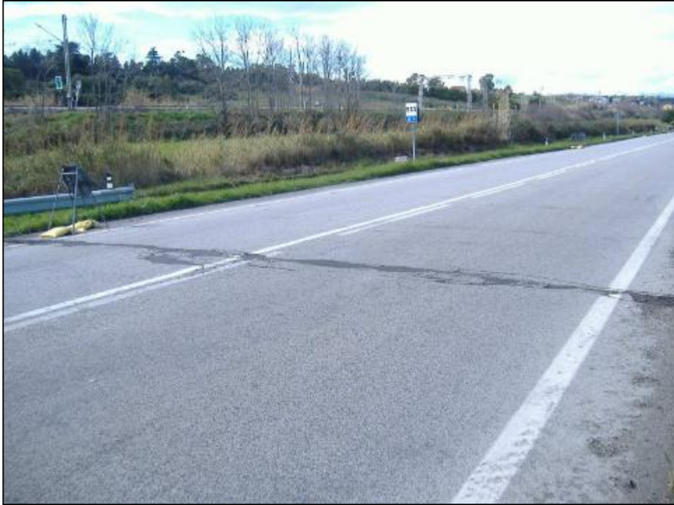
Figura 8-45 Lesioni sulla pavimentazione stradale della s.s. 16 adriatica (F.26).
