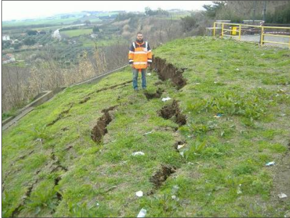
Figura 8-21 Fratture sul ciglio della scarpata di fronte alla vecchia chiesa di Petacciato (F.1).
