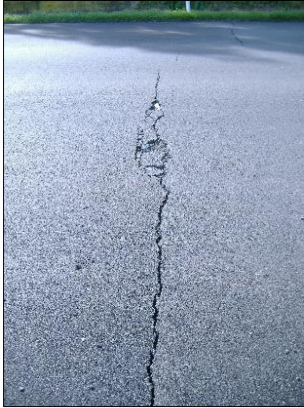
Figura 8-43 Lesioni sulla pavimentazione stradale della s.s. 16 adriatica (F.24).
