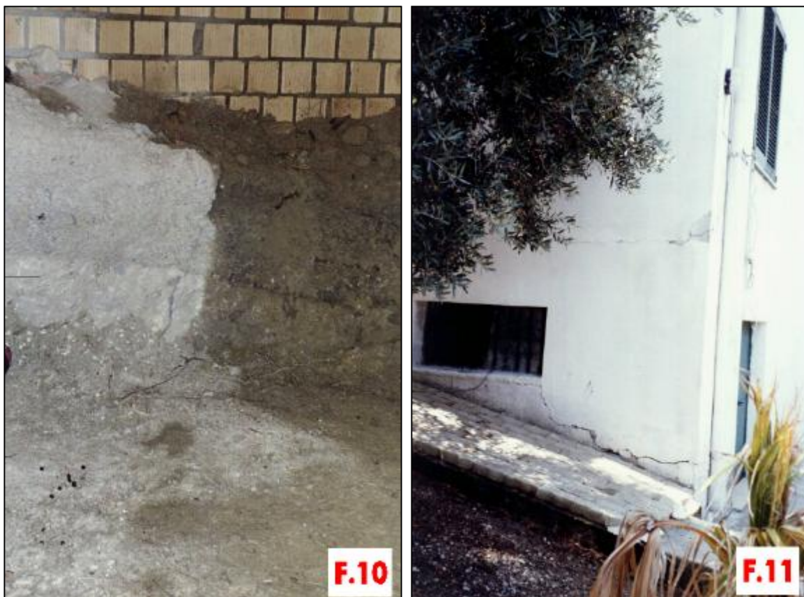
Figura 8-11 Località "Fonte Ravanelli" – Lesioni sugli edifici (F10 e F11).
