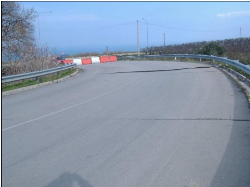
Figura 8-33 Fratture sulla pavimentazione della S.P. litoranea, direzione NORD-OVEST (F.14).
