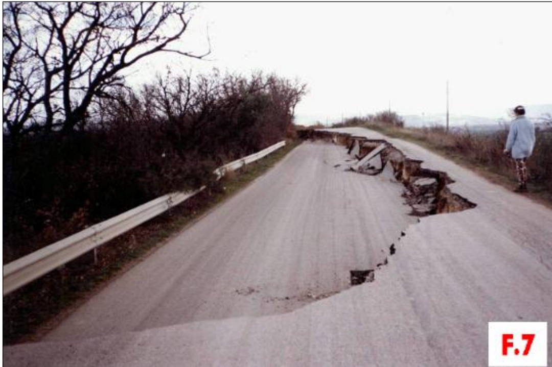
Figura 8-8 Località Vaccareccia – Lesione sulla strada di forma concava ad arco (F7).
