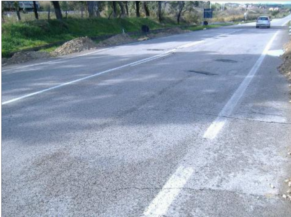
Figura 8-44 Lesioni sulla pavimentazione stradale della s.s. 16 adriatica (F.25).
