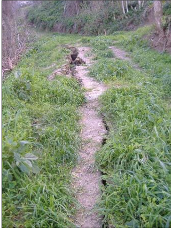
Figura 8-34 Fratture nei terreni al margine della S.P. di Petacciato, direzione NORD (F.15)
