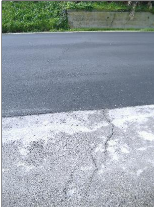
Figura 8-46 Località "Torre di Petacciato" Lesioni sulla pavimentazione stradale della s.s. 16 adriatica (F.27).
