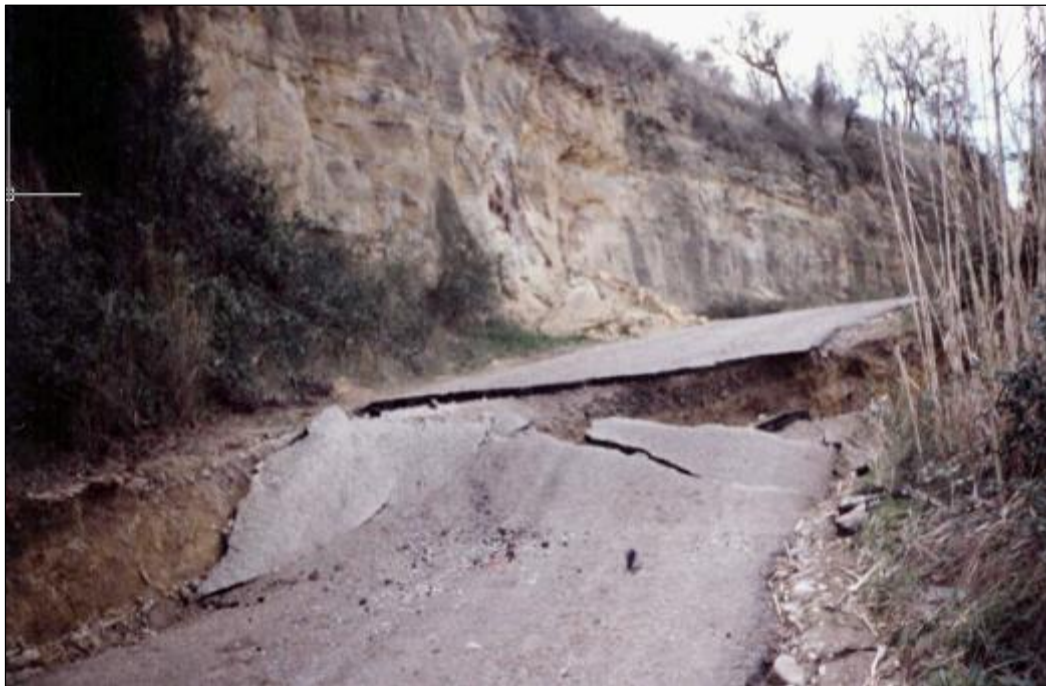
Figura 8-7 Località Cava della Ripa – Particolare strada e smottamento falesia (F6).
