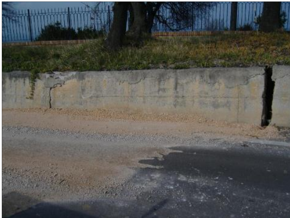
Figura 8-29 Lesione di Figura 8-28 che ha interessato anche il muro di recinzione di una abitazione (F.10).
