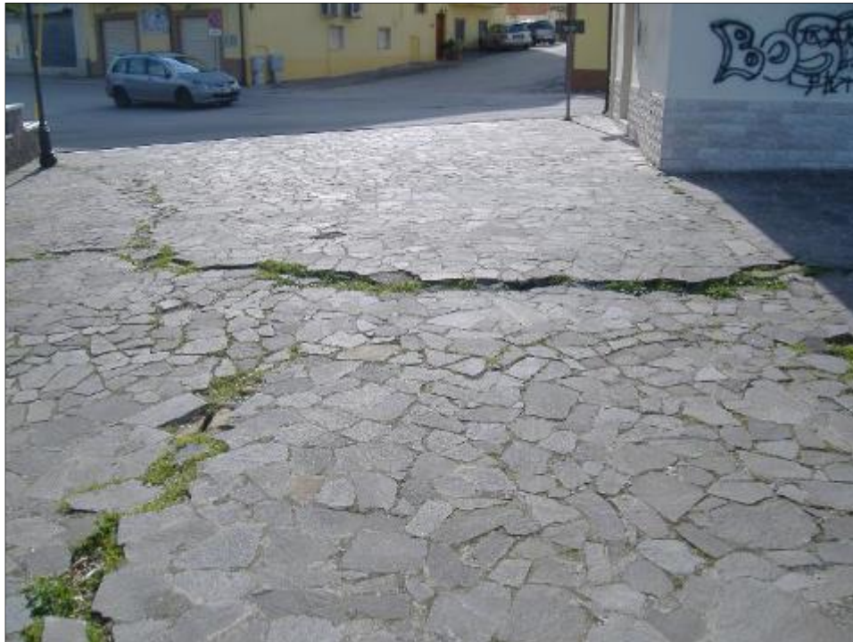
Figura 8-24 Continuazione verso Est delle lesioni di Figura 8-21 (F.4).
