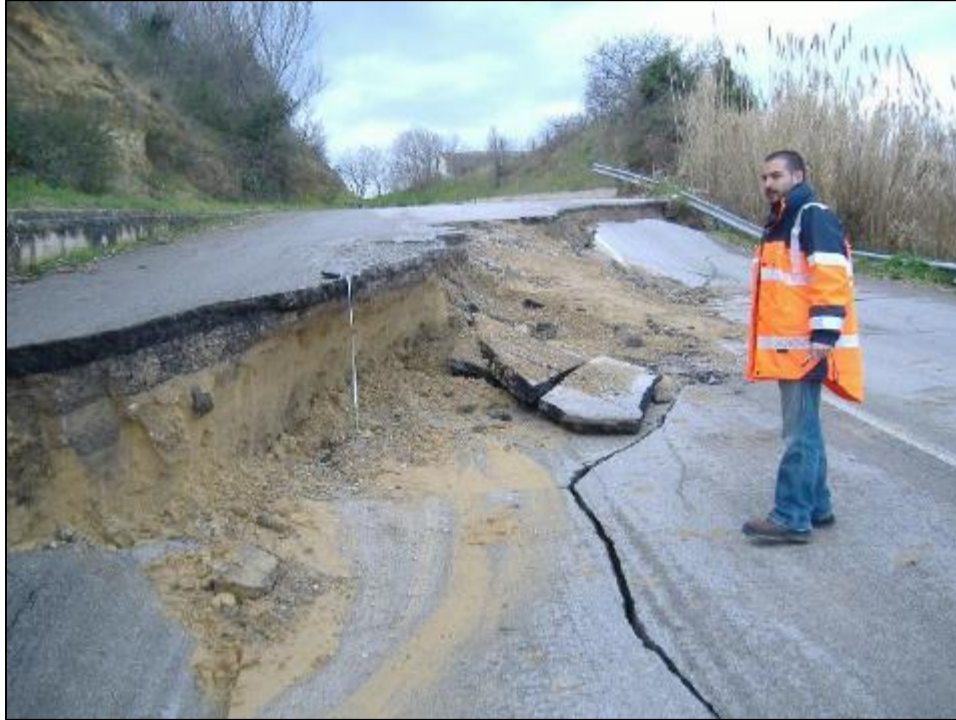
Figura 8-25 Località "Cava della Ripa" – ampia lesione sulla strada comunale (F6).
