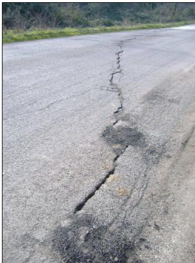
Figura 8-30 Fratture sulla pavimentazione sulla S.P. litoranea (F.11).
