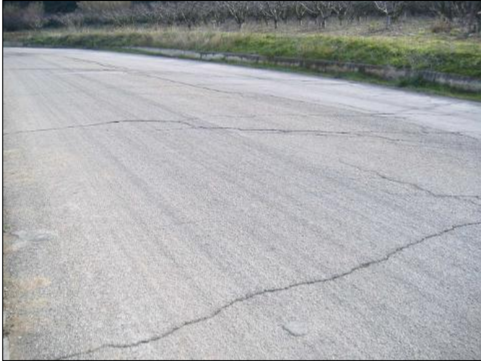
Figura 8-32 Fratture sulla pavimentazione della S.P. litoranea direzione NORD-OVEST (F.13).
