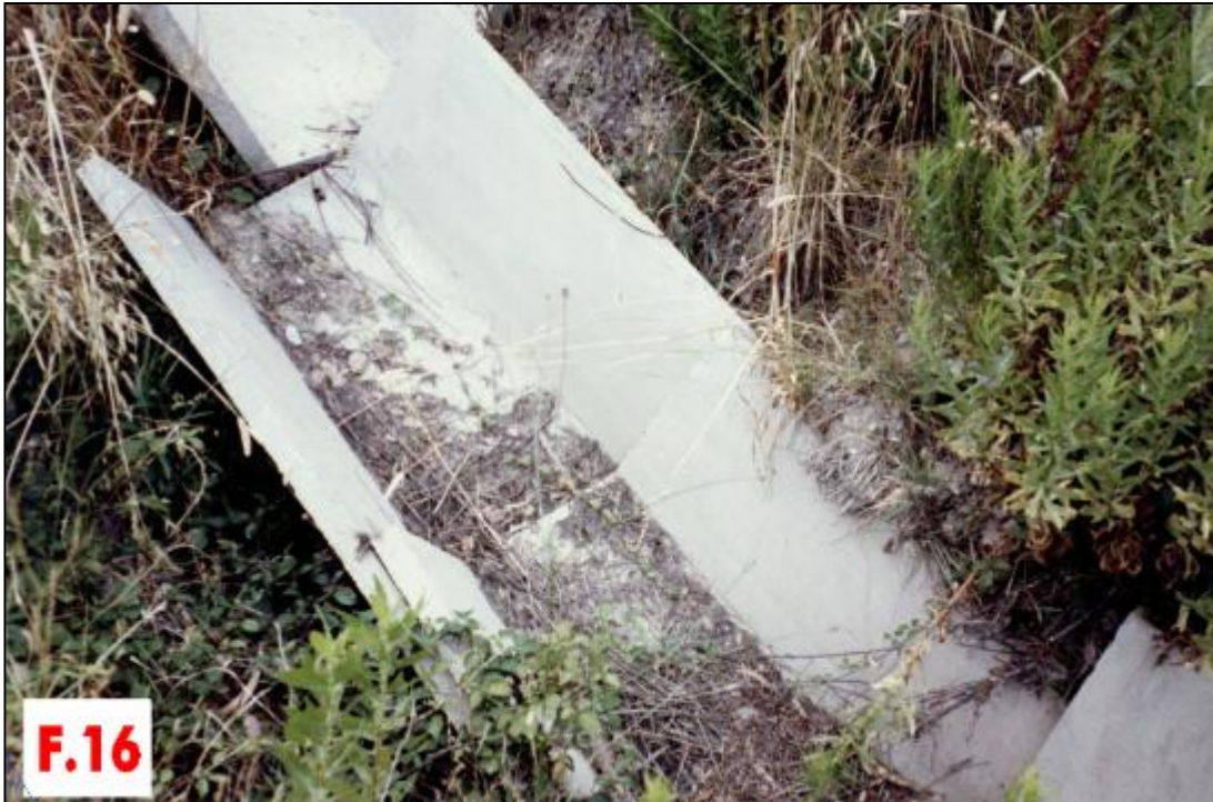
Figura 8-16 Lesioni sulla canaletta di rivestimento del fosso Cacchione in prossimità del viadotto autostradale (F16).
