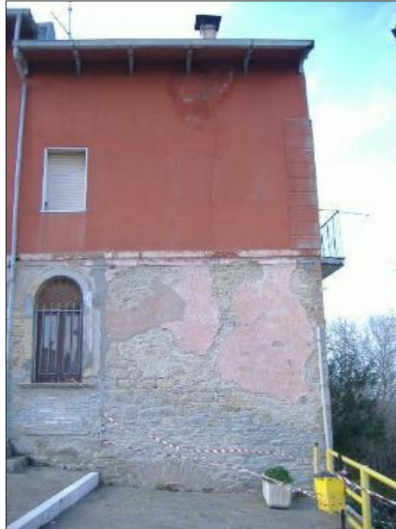
Figura 8-23 Lesioni alle strutture murarie di abitazioni ubicate in prossimità del piazzale (F.3).
