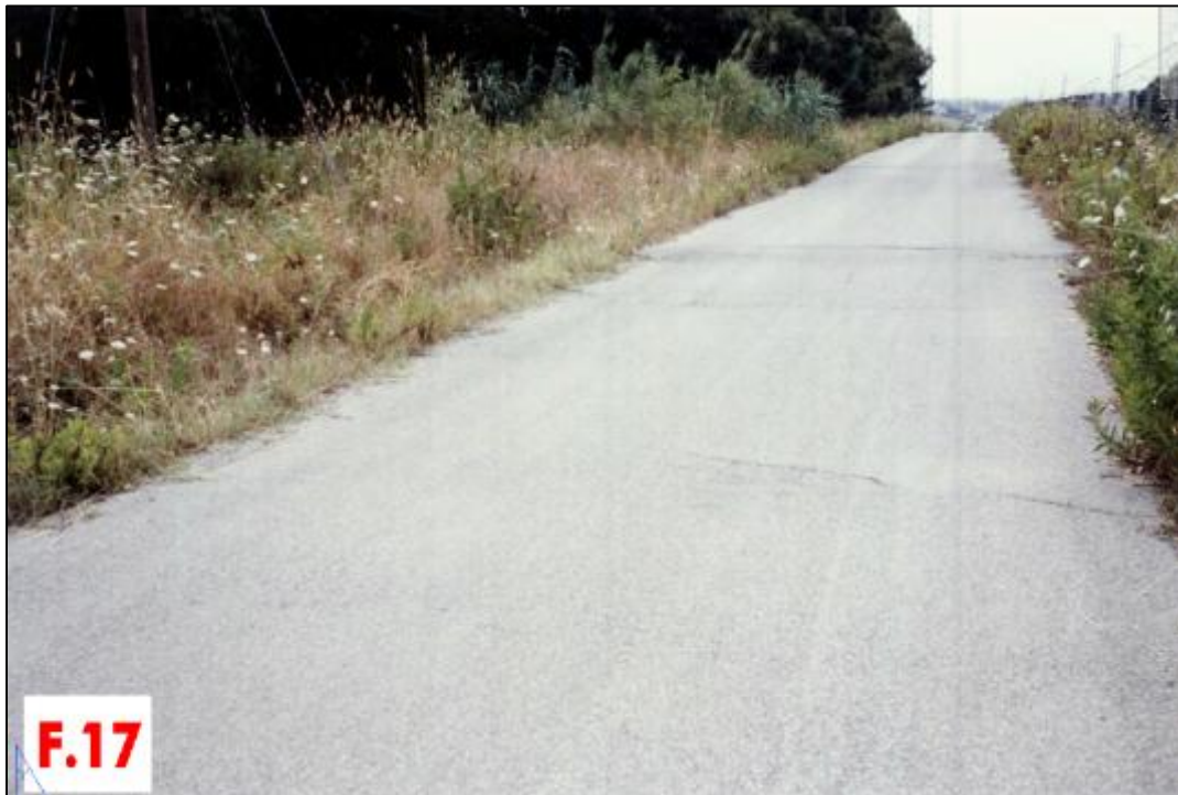
Figura 8-17 Lesioni sulla strada vicinale a valle del viadotto Cacchione (F17).
