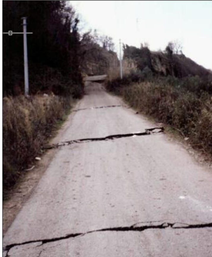
Figura 8-6 Località Cava della Ripa –Lesioni sulla strada (F5).
