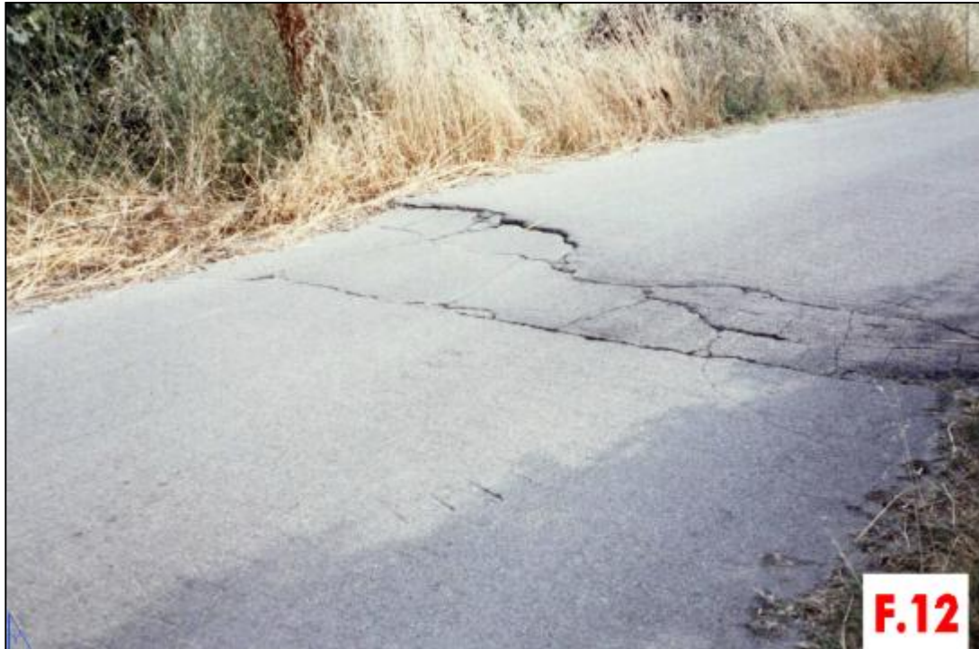
Figura 8-12 Strada vicinale in località "Colle degli Ulivi" – Lesioni sulla pavimentazione (F12).
