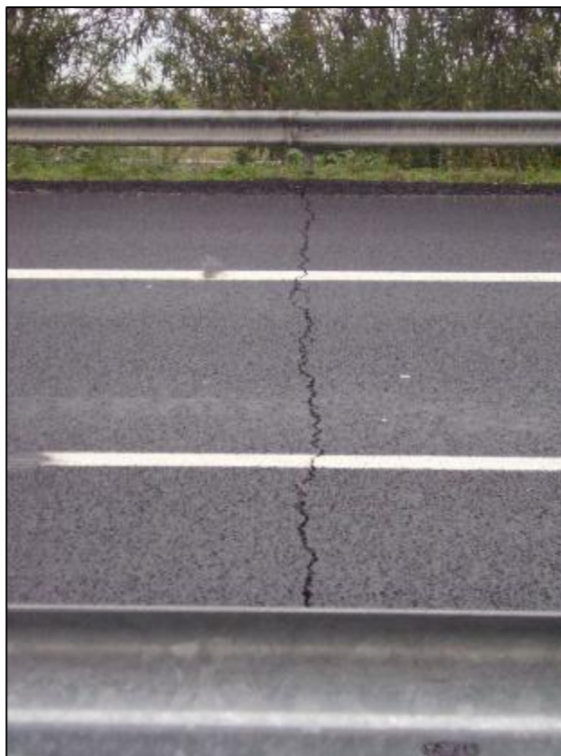
Figura 8-41 Lesione sulla pavimentazione autostradale in carreggiata nord (F.22).
