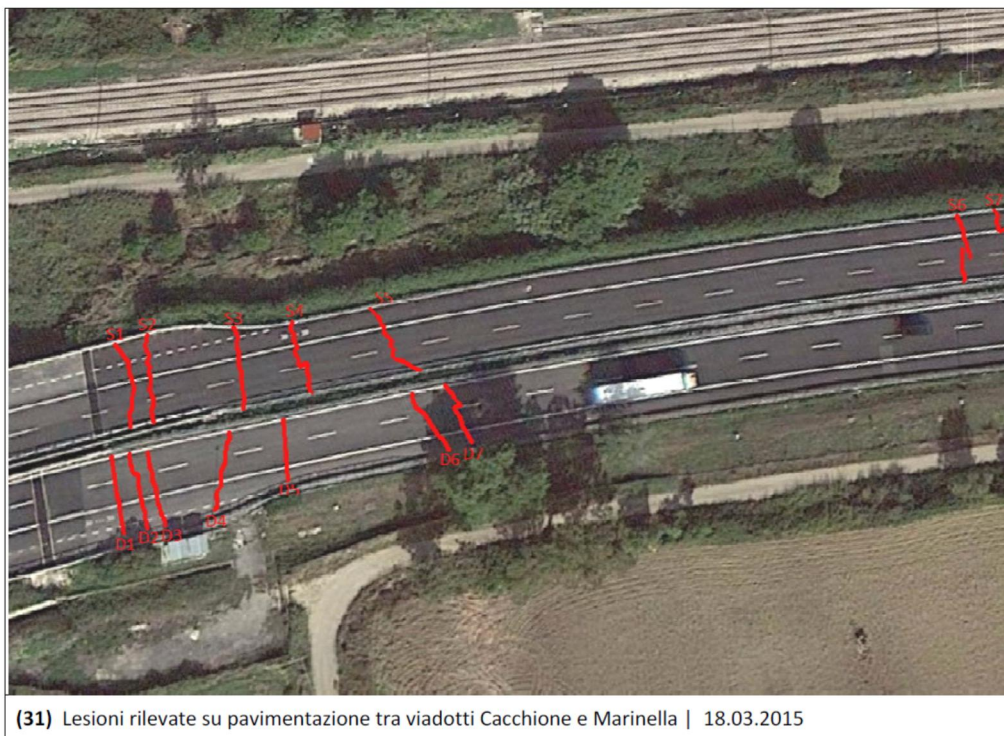
Figura 8-50. Viadotto Cacchione – Riattivazione 2015: Lesioni nella pavimentazione stradale nel tratto di rilevato compreso tra il Viadotto Cacchione ed il Viadotto Marinella.
