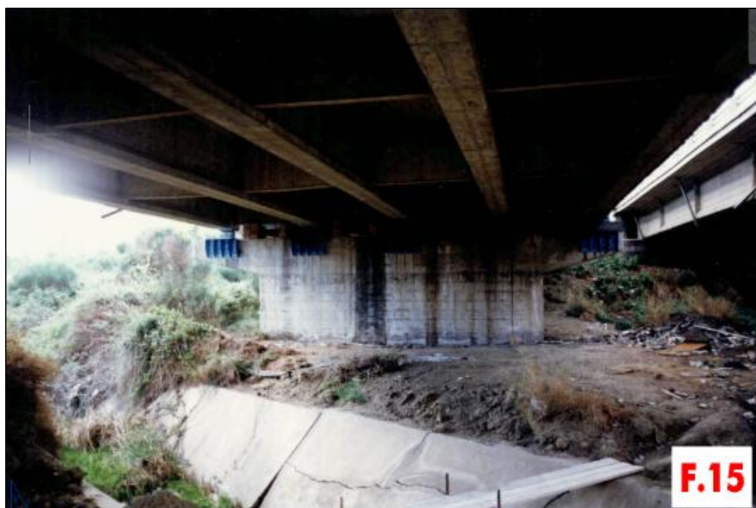
Figura 8-15 Lesioni sul rivestimento della canaletta del fosso Cacchione in corrispondenza del viadotto autostradale (F15).
