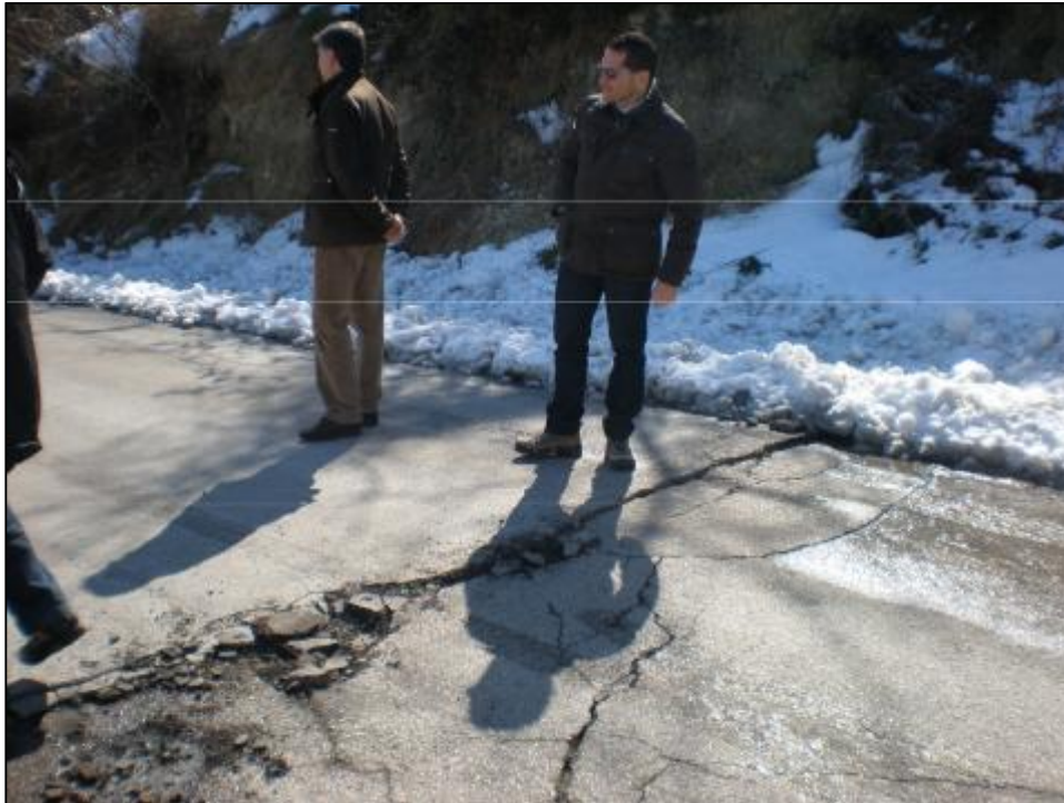
Figura 8-36 Frattura nella pavimentazione stradale della S.P. di Petacciato (F.17).
