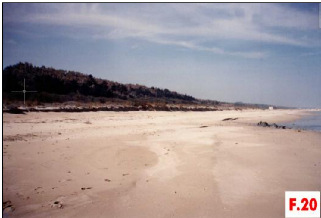
Figura 8-20 Spiaggia – sollevamento berma in corrispondenza delle argille (F20).
