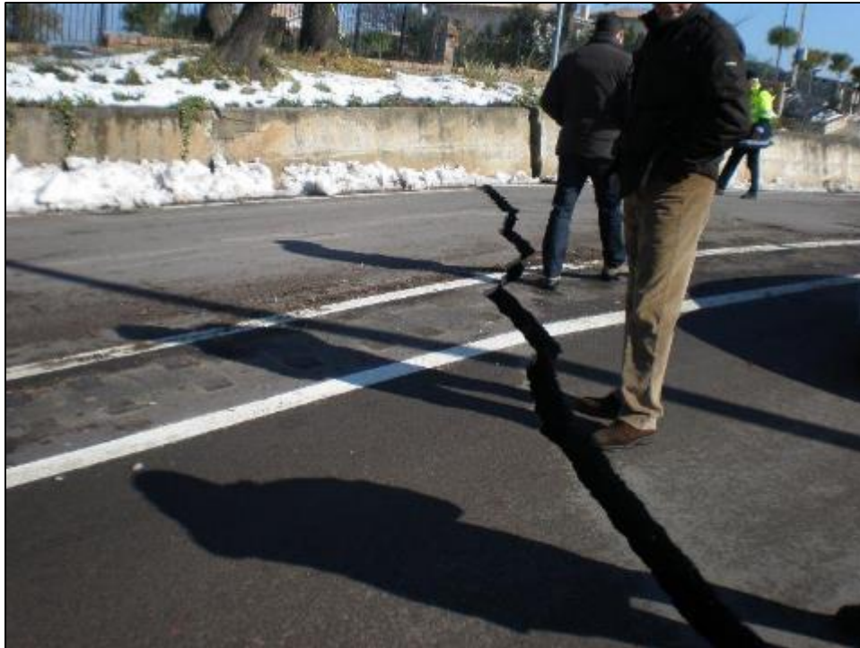
Figura 8-28 Lesione sulla strada provinciale di Petacciato (F.9).
