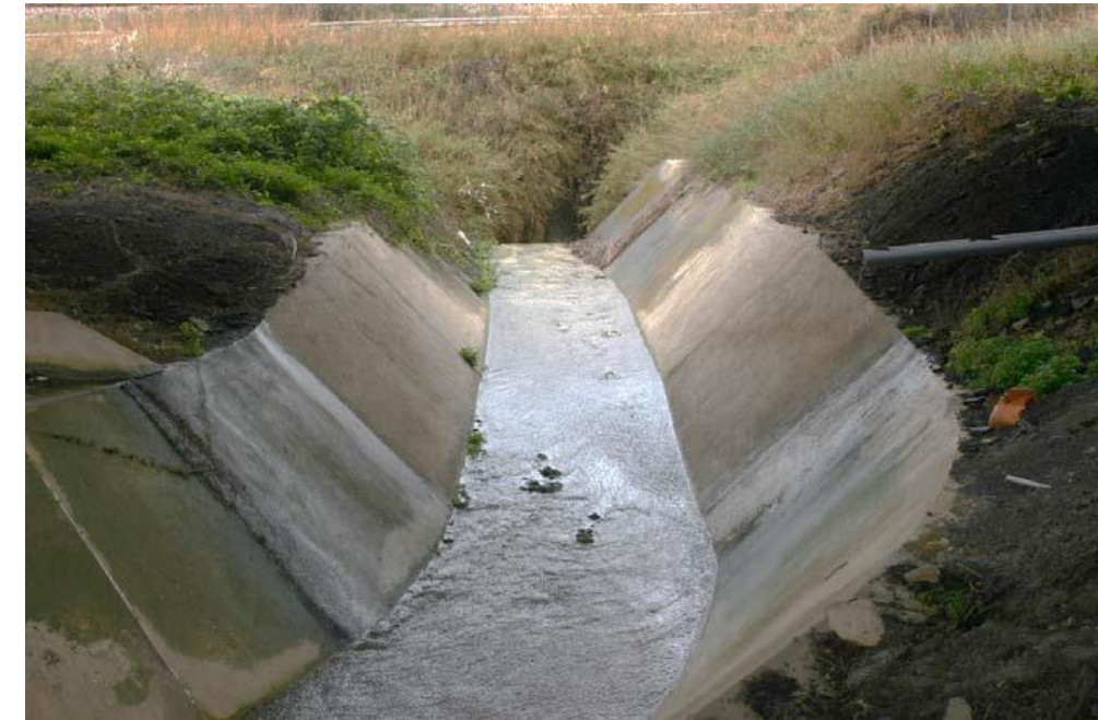
Figura 2-4. Fosso Cacchione e caditoia del tombino idraulico di sottopasso della ferrovia (vista verso mare)
