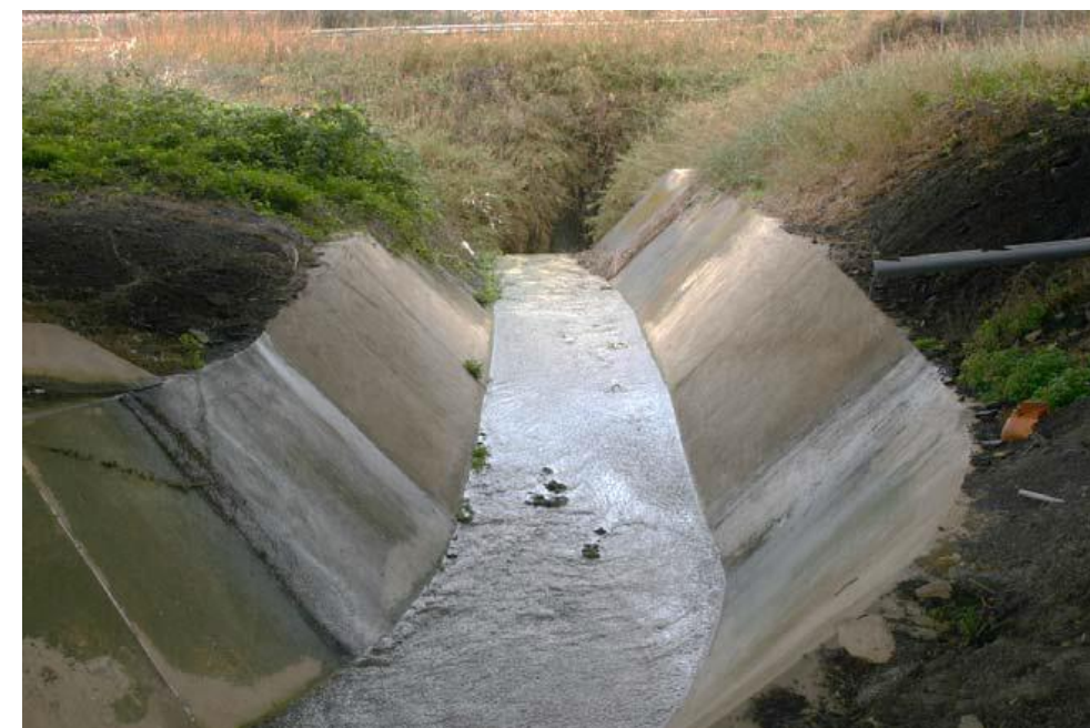
Figura 4-9. Fosso Cacchione e caditoia del tombino idraulico di sottopasso della ferrovia (vista verso mare)
