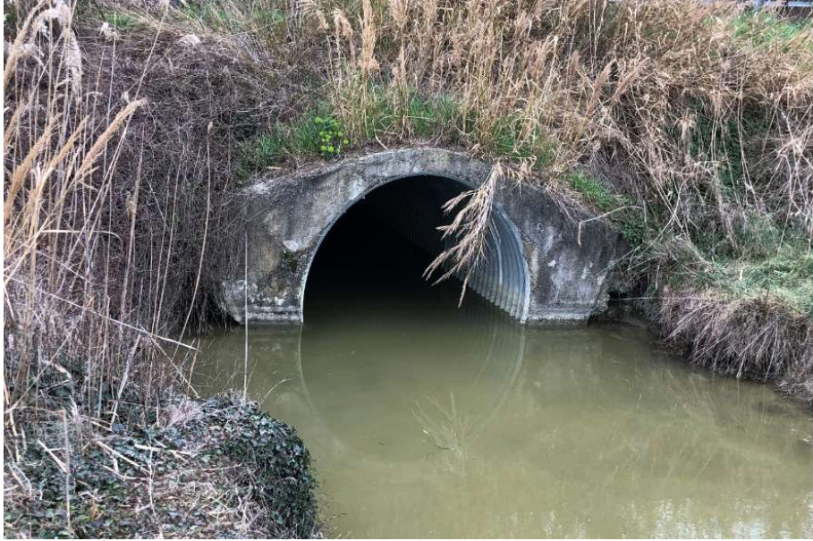
Figura 7: Stato di fatto Canaletta Inferiore Destra
