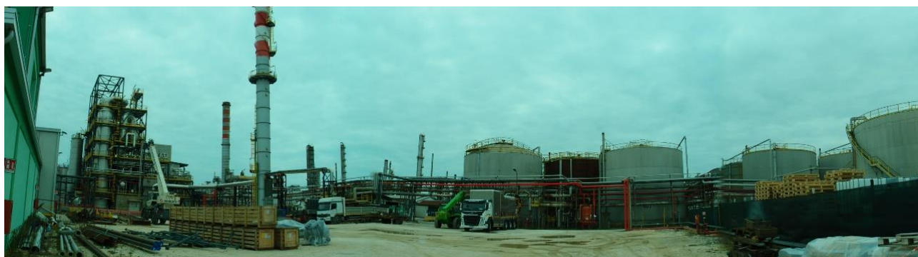
Figura 4-2: Area in cui verranno realizzate le opere, allo stato attuale (vista panoramica da nord ovest)
