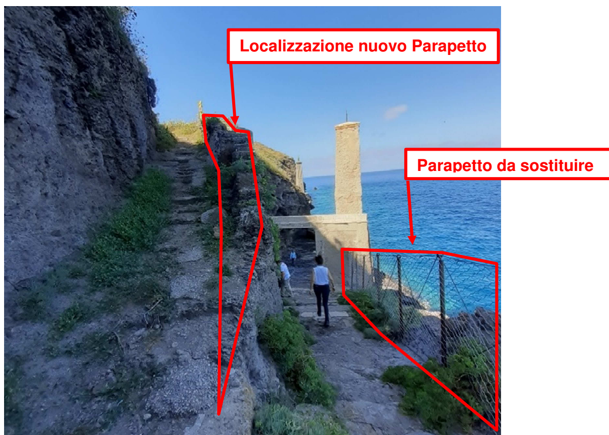
Figura 38. Ripristino localizzato delle pavimentazioni, pulizia sfalcio e sostituzione e/o realizzazione nuovi parapetti
