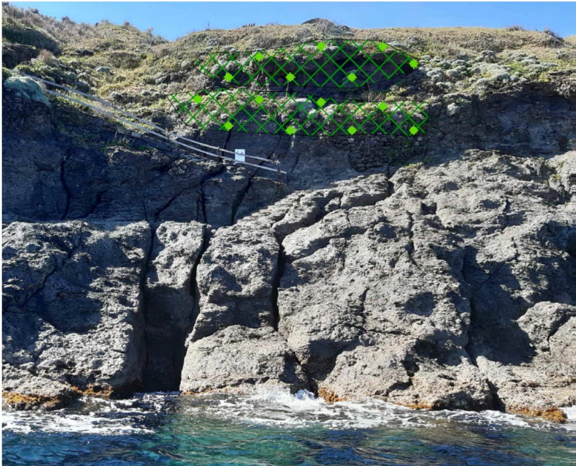
Foto 5: Parte alterata della falesia da proteggere – INTERVENTO 2
