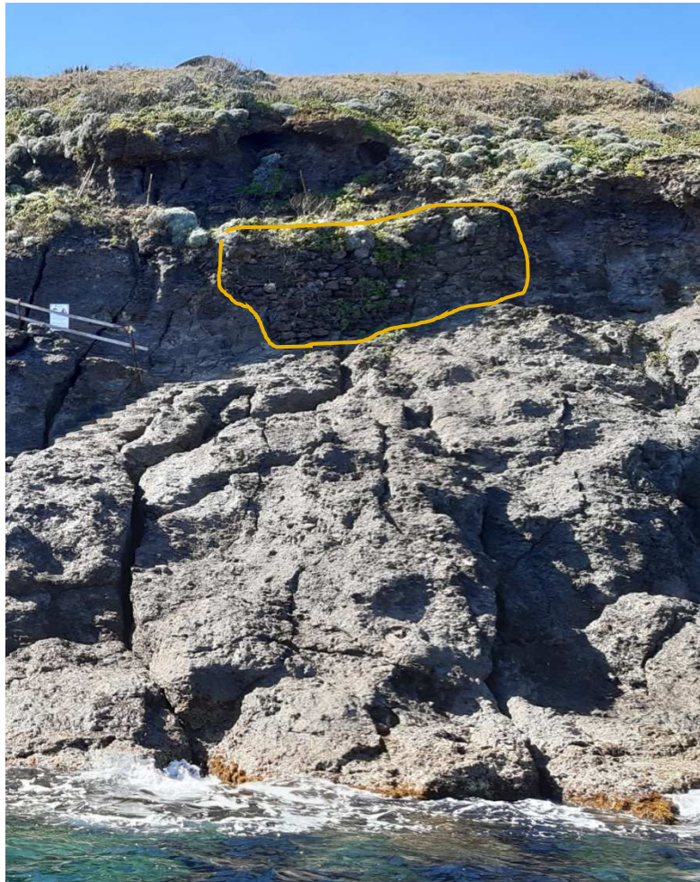
Foto 4: Estensione indicativa dell'INTERVENTO 1 sul muro degradato
