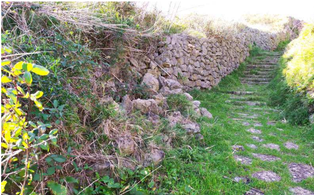
Foto 7: Muri a secco crollati o in fase di crollo
