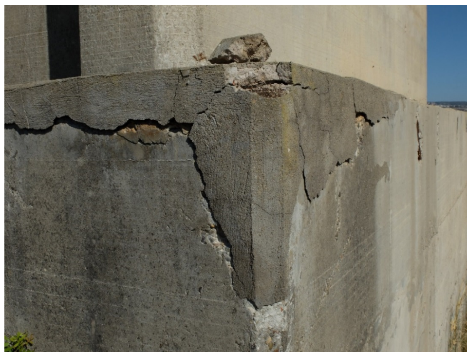
Ammaloramenti su pile
