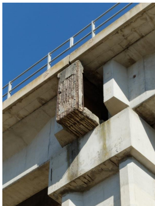
Ammaloramenti su strutture di supporto della T.E. (“candelabri”)
