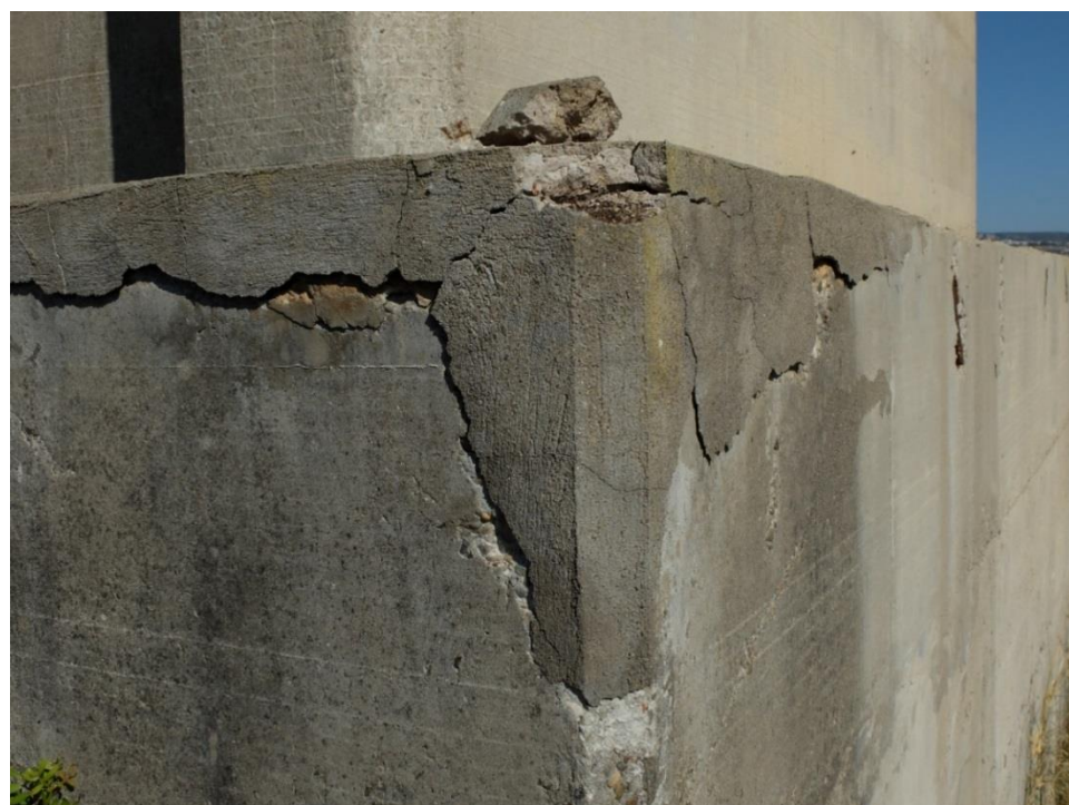
Ammaloramenti su pile
