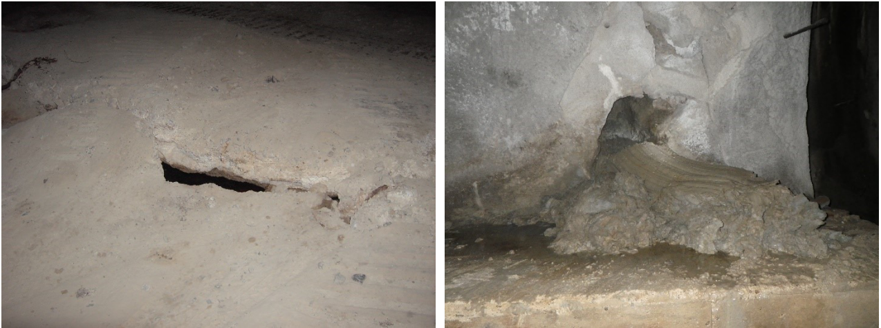
Figura 11. Esempi di cavità riscontrate nel rivestimento della Galleria: a destra fuoriuscita di fango rifluito dalla cavità
