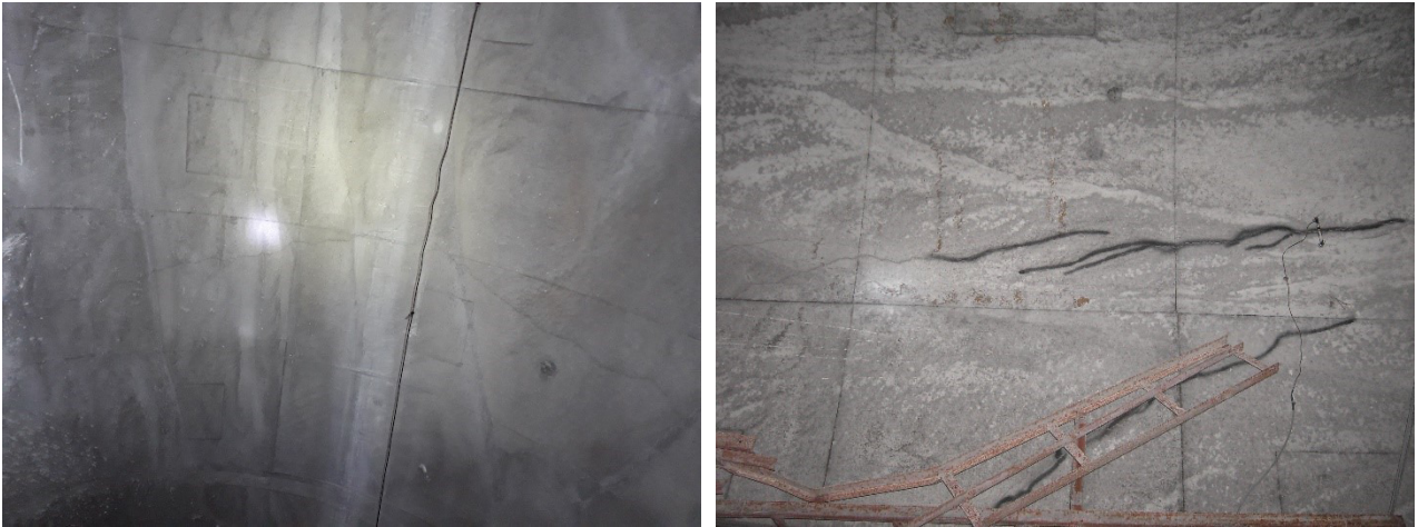
Figura 14. Lesioni in calotta e sui piedritti
