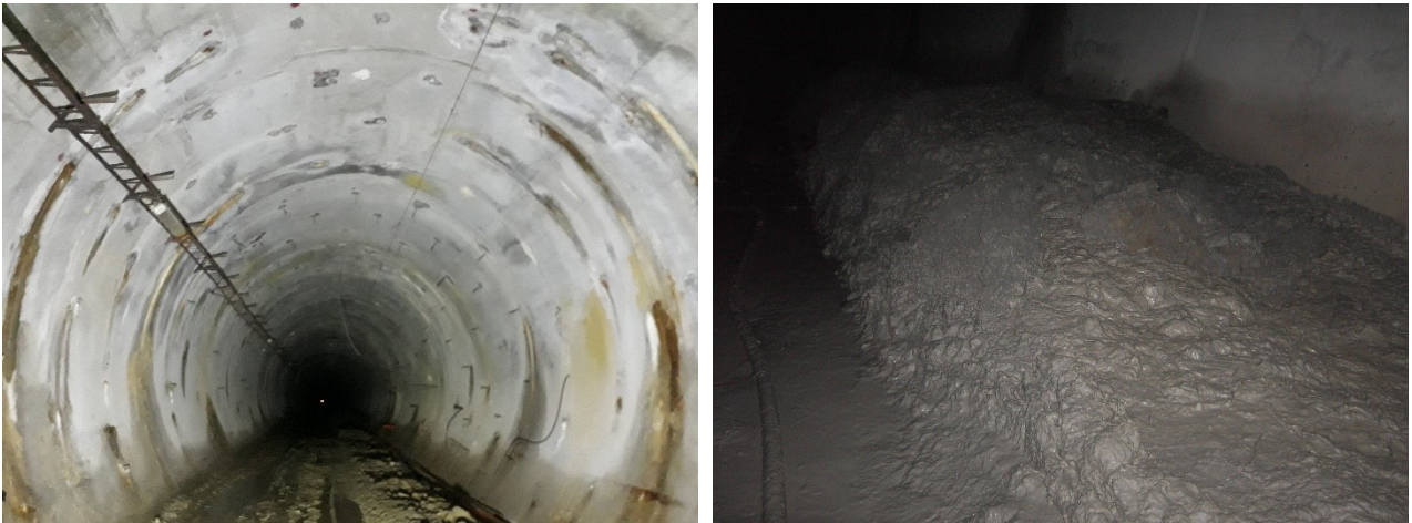
Figura 15. Fessure nelle discontinuità dei getti (a sinistra) e materiale sul piano di calpestio della Galleria (a destra)
