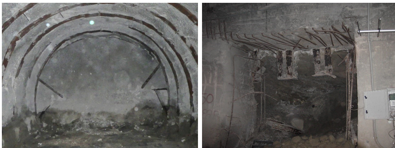
Figura 17. Immagini di nicchioni con rivestimento provvisorio in pessimo stato di conservazione. Nella figura di destra sono visibili le centine danneggiate.
