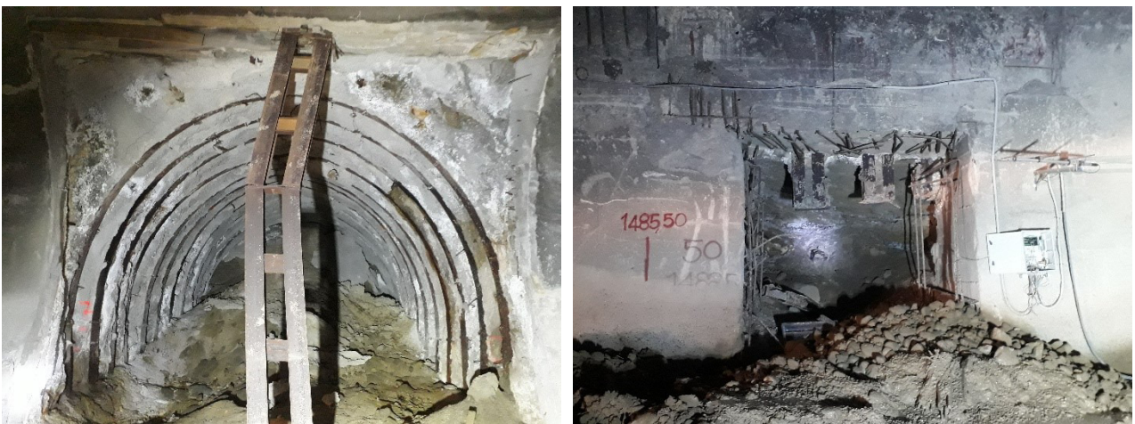
Figura 16. Immagini di nicchioni con rivestimento definitivo assente (a sinistra) ed incompleto (a destra)
