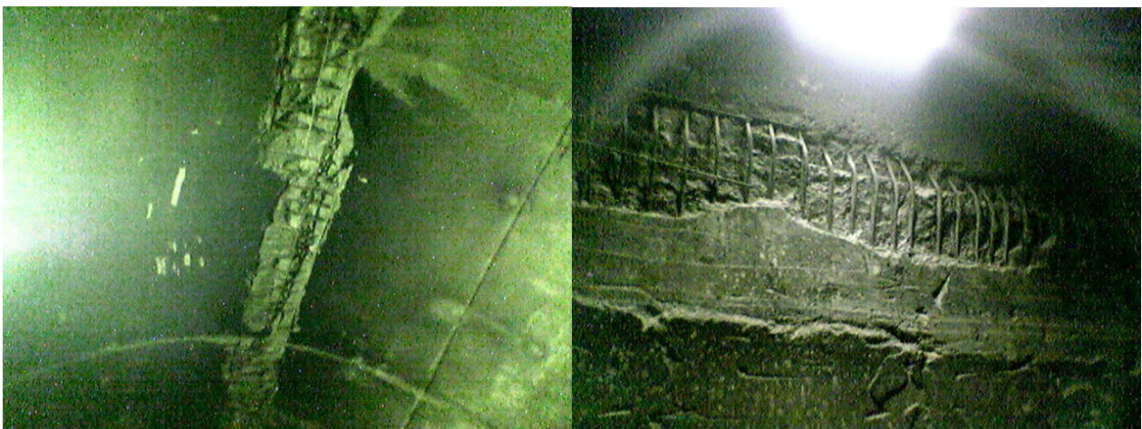
Figura 13. Lesioni in calotta e sui piedritti, con armatura a vista
