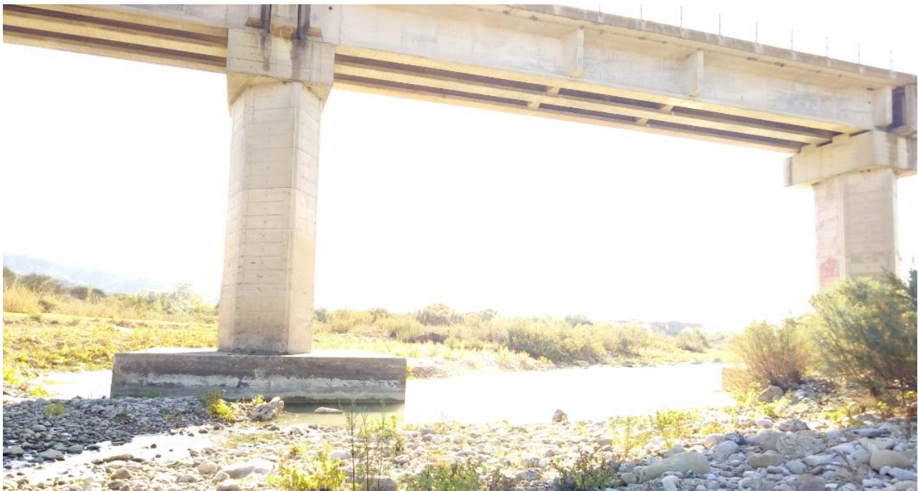
Figura 8 – Viadotto esistente VI01 sul F. Basento: attuale scalzamento delle pile in alveo.
