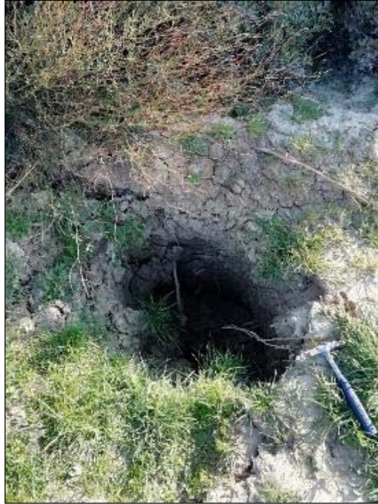
Figura 13-11 – Inghiottitoio causato dall’infiltrazione delle acque superficiali.
