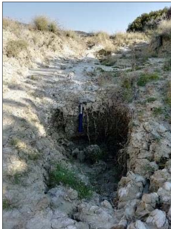
Figura 13-10 – Inghiottoio causato dall'infiltrazione delle acque superficiali (F.15).
