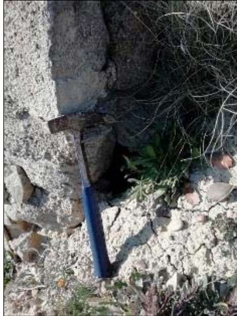
Figura 13-14 - Particolare di sottoescavazione del muro di contenimento stradale.
