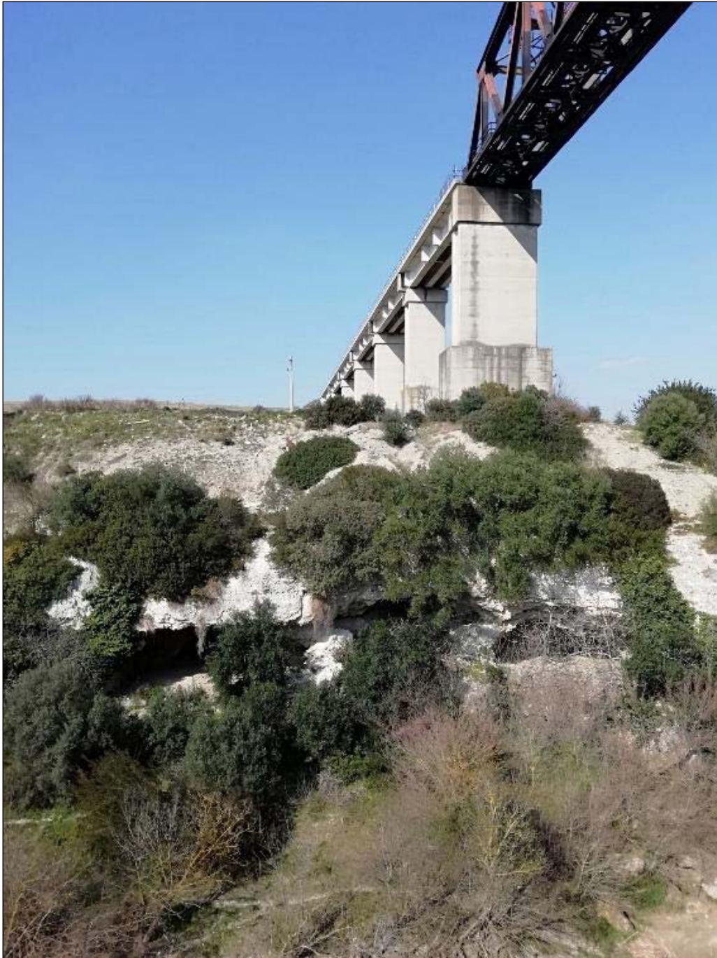
Figura 13-46 - Travata metallica della linea Ferrandina-Matera sul torrente Gravina. Al disotto della pila Nord si identificano cavità carsiche di decine di metri di profondità e larghezza e diversi metri in altezza.
