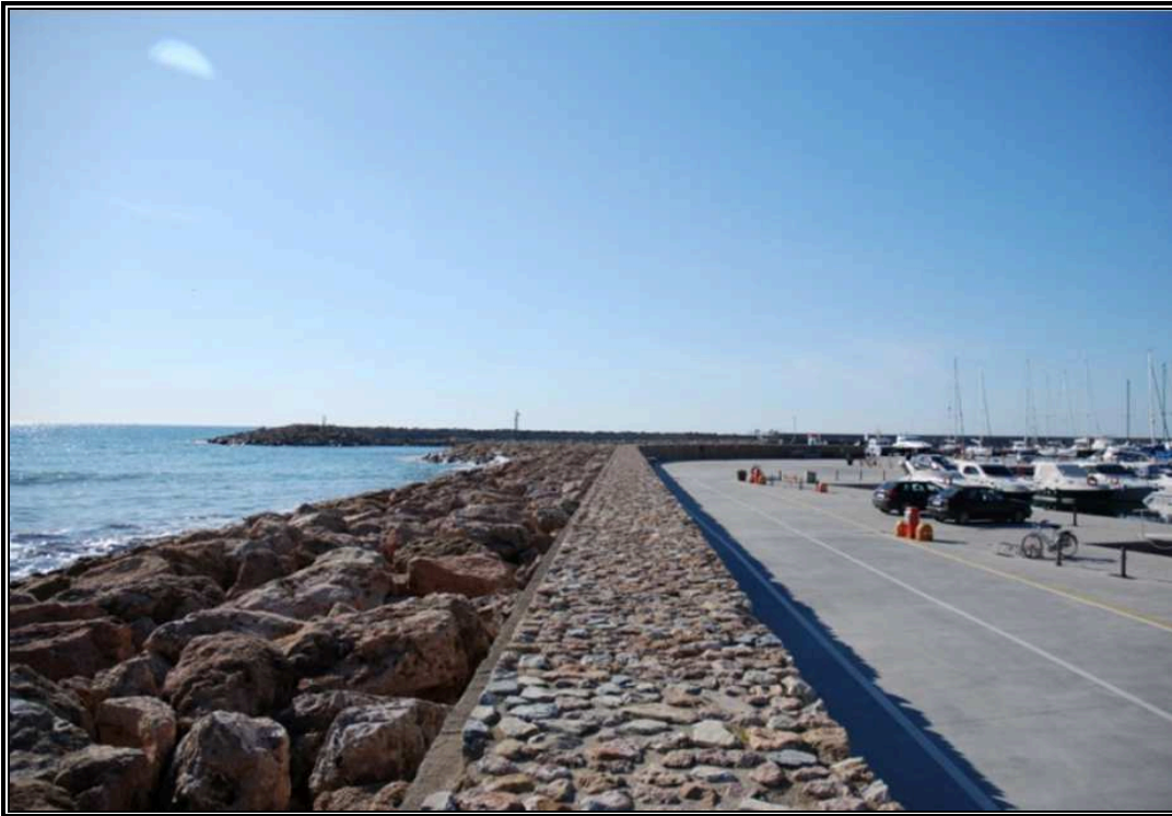
Stato attuale del muro e della mantellata della diga di sottoflutto
