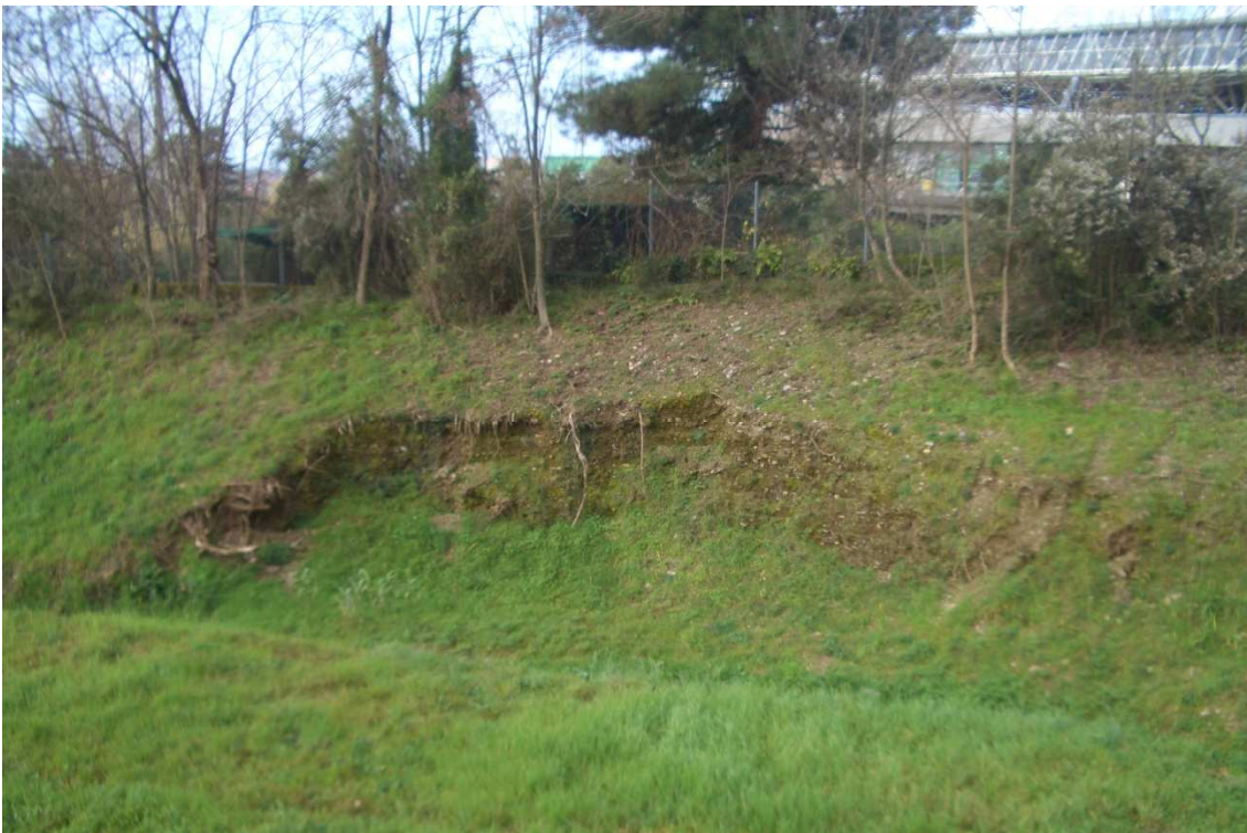
Fig. 4.11. Crollo lungo la sponda del T. Canal Magro
