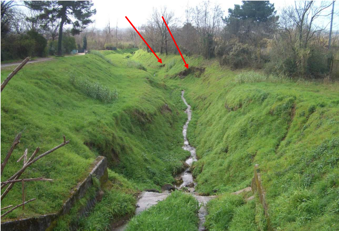
Fig. 4.10. Crolli lungo le sponde del T. Canal Magro innescati da erosione
