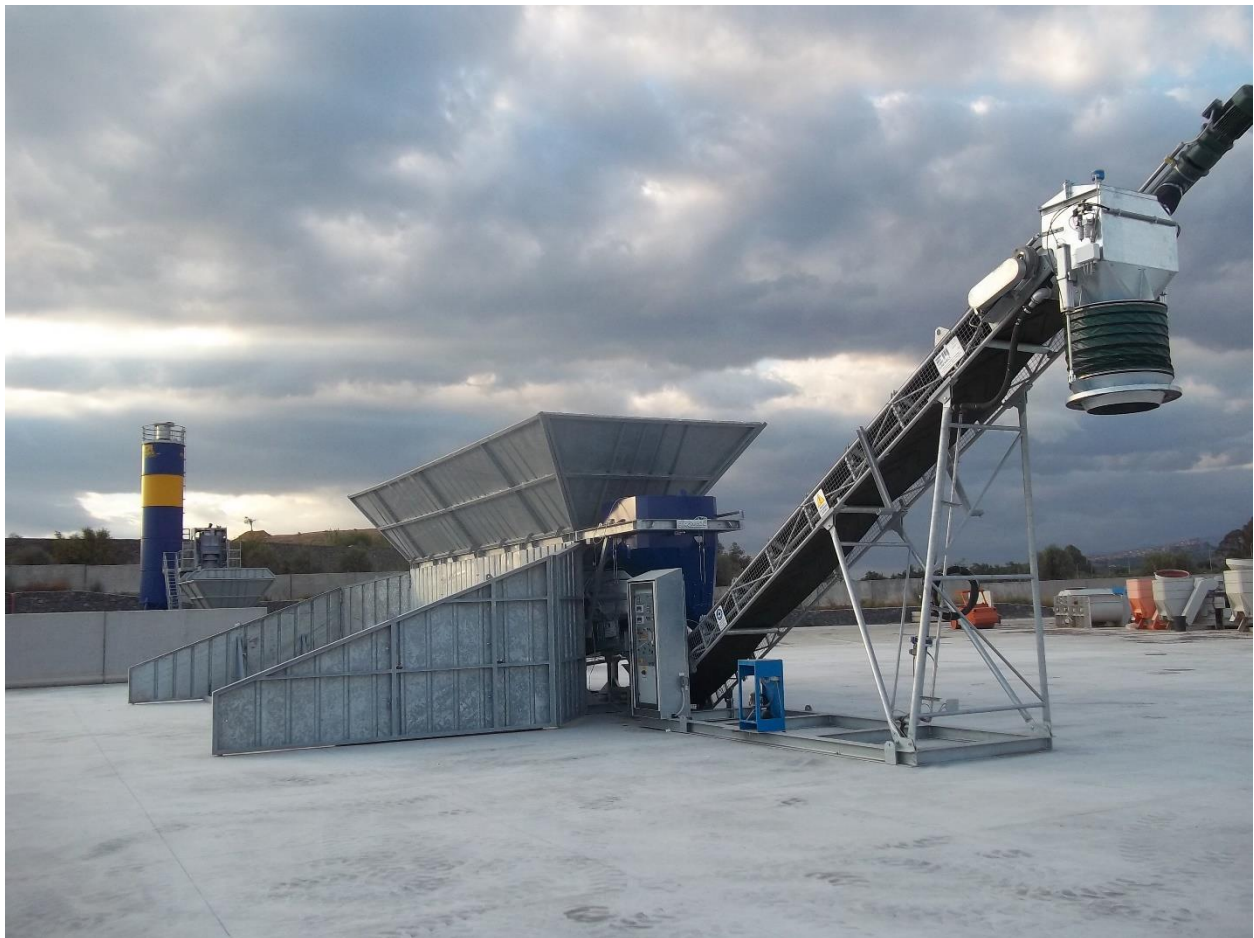
Figura 14 Esempio di impianto di betonaggio semovente in esercizio
