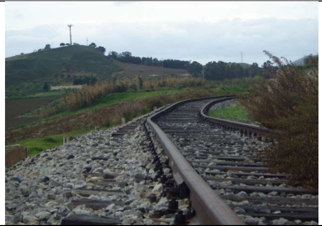
Cedimento Piano Ferroviario – Lotto 2
