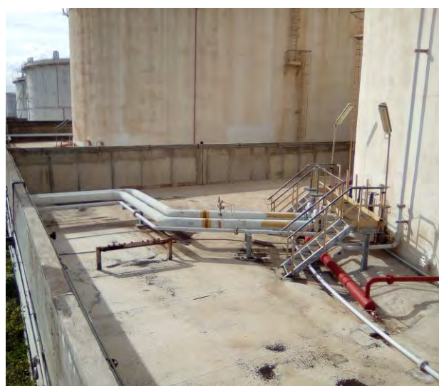
Figura 43: Particolare della pavimentazione in cemento del bacino di contenimento
