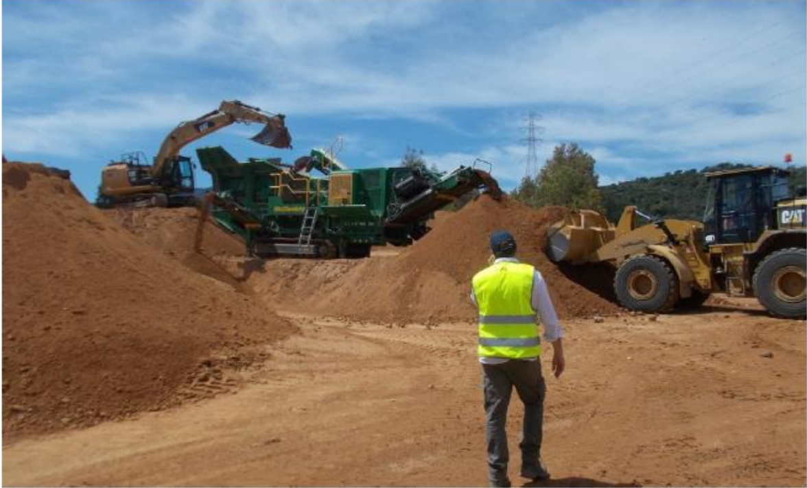
Figura 3 – Mezzi operativi utilizzati nelle attività dell'impianto di frantumazione – vagliatura
