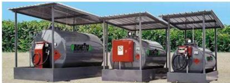
Figura 8– Esempi di impianti fisso di distribuzione carburante
