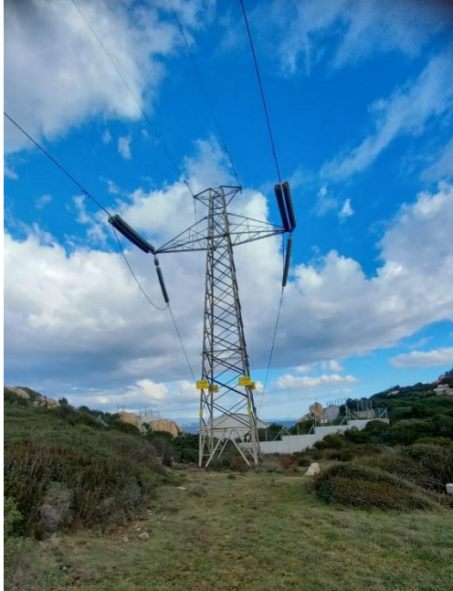
Figura 7.2: Foto traliccio 1 e fabbricato punto di transizione
