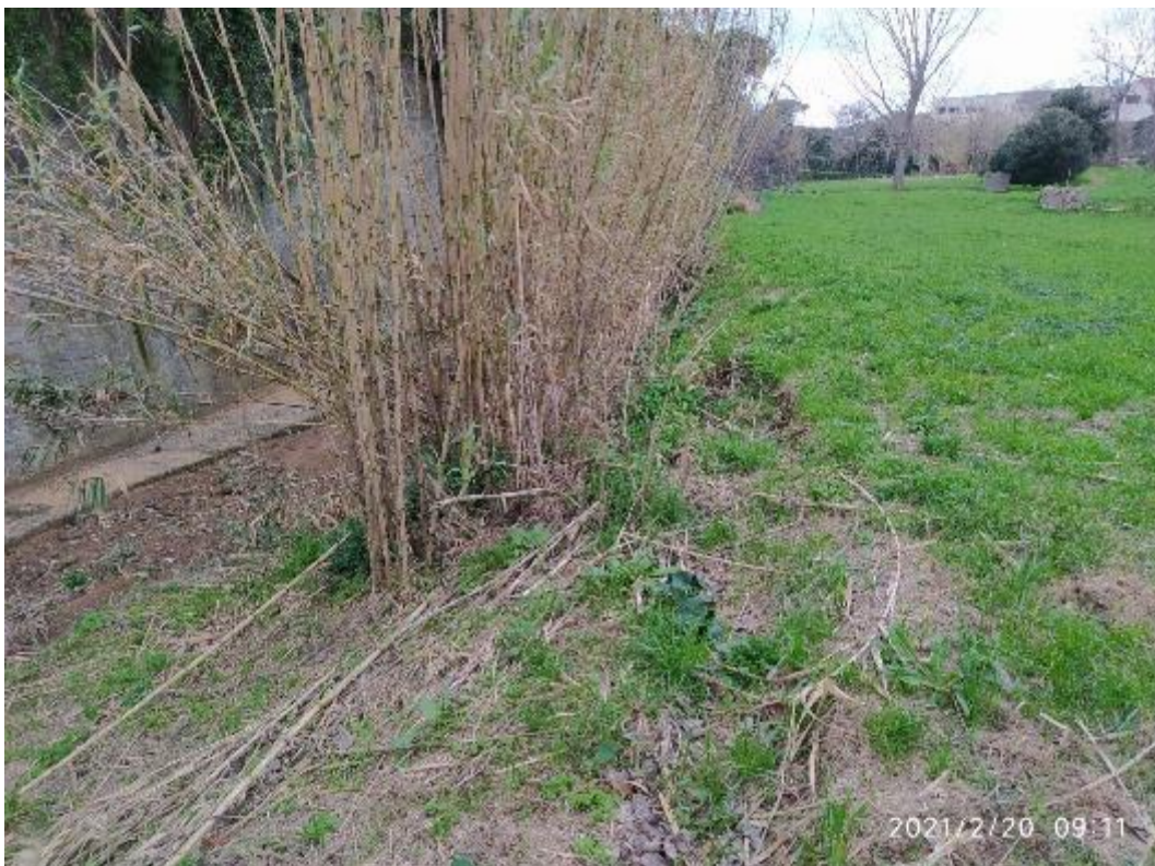
Figura 4.40: Fenomeni di erosione di sponda del Rio Salivoli lungo la scarpata di terrazzo.
