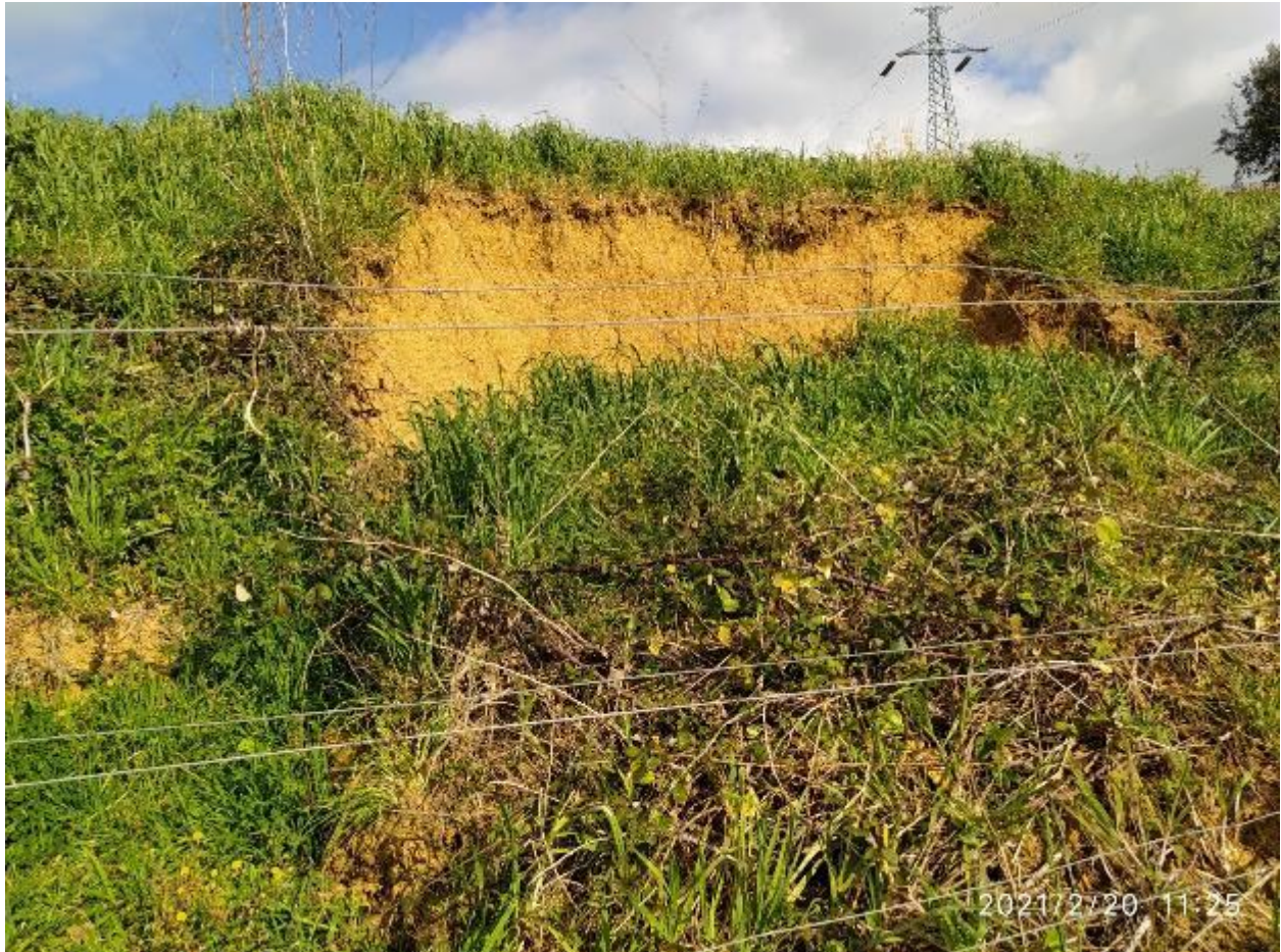
Figura 4.53: Fenomeno di smottamento della scarpata del gradone della vigna.
