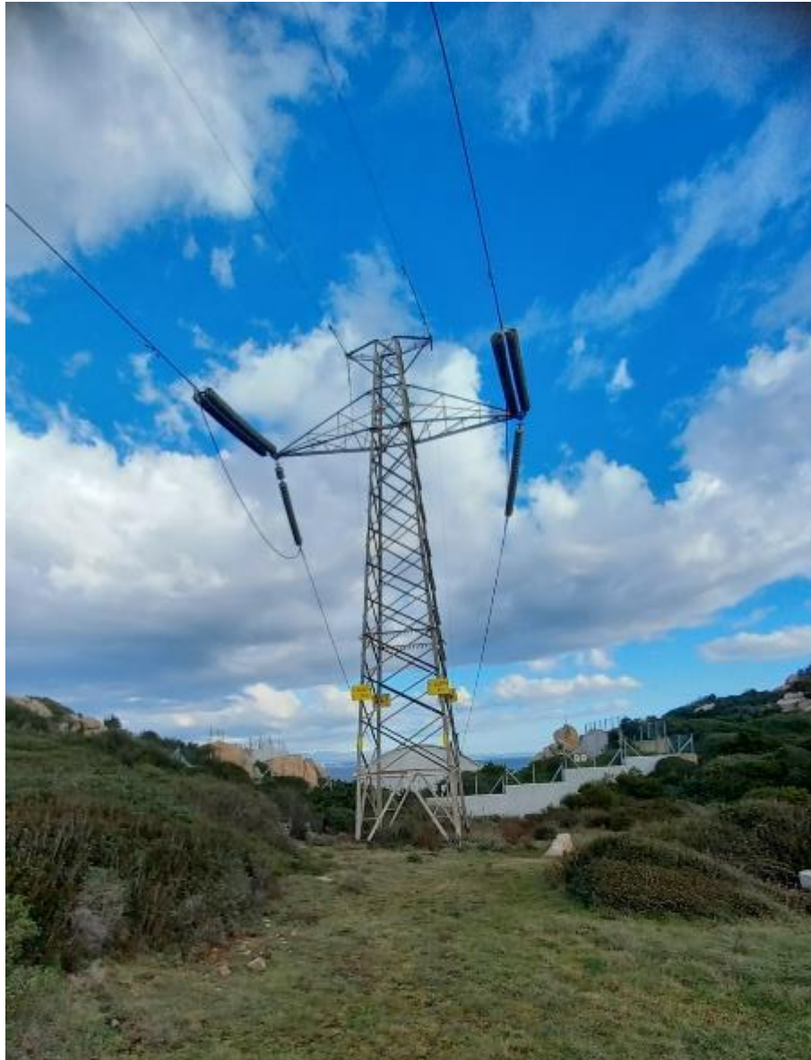
Figura 10.56: Foto traliccio 1 e edificio del punto di transizione aereo-cavo
