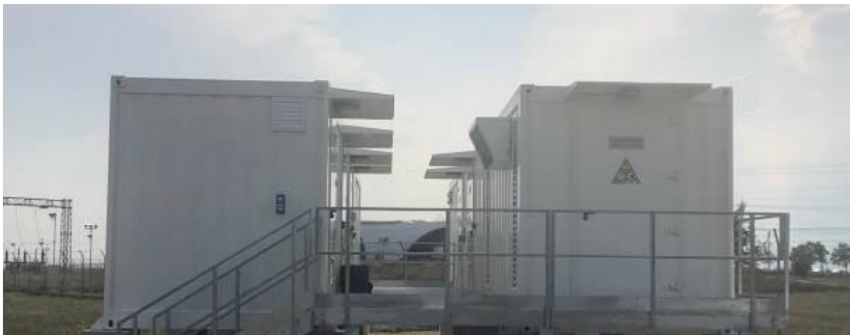
Figura 38: Esempio di installazione sistema BESS in impianto
