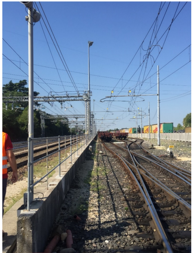
Foto 12 – 1°-2°-3° Binario Presa/Consegna scalo RBN
