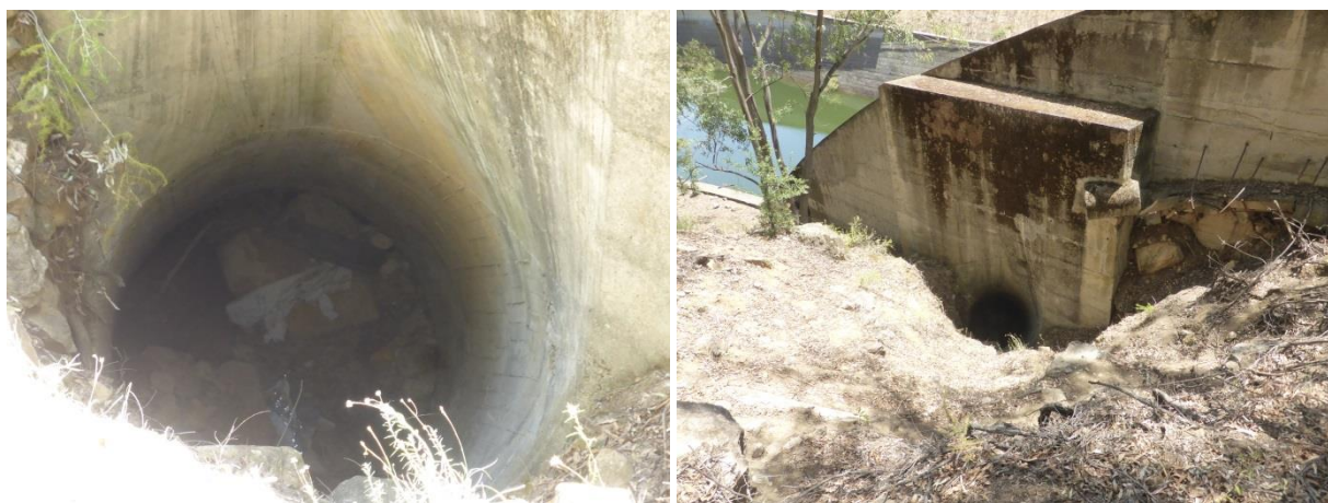
Figura 4-14: deposito di sedimento all'interno della caditoia intasato dai sedimenti dell'area in dissesto
