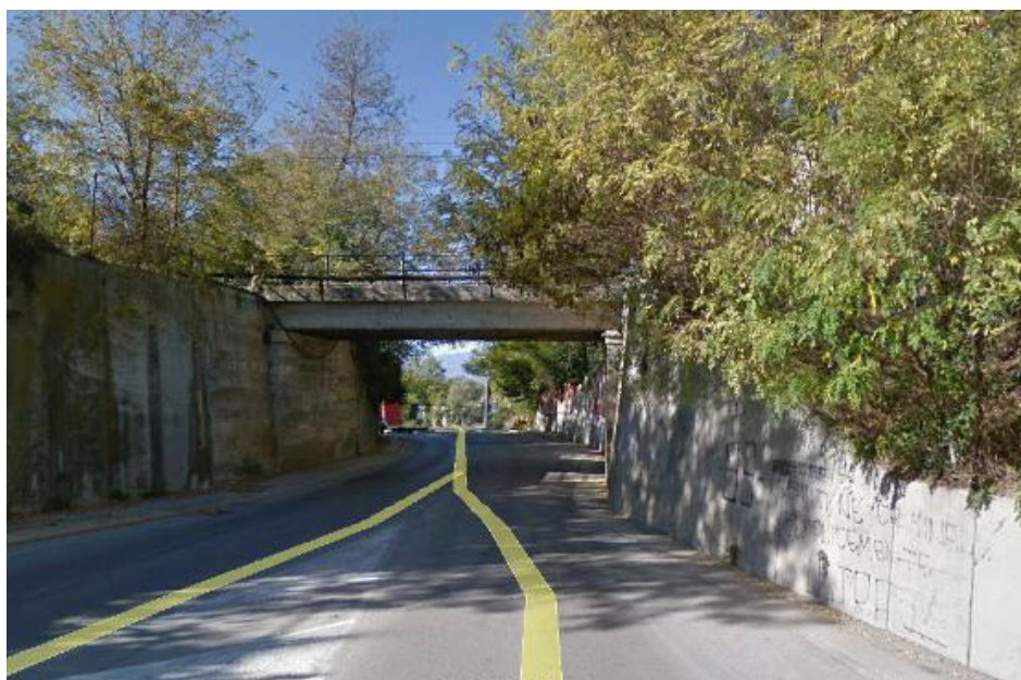
Fig. 54 – Viabilità stradale Via Tirino, sottovia al km 14+250.00 (NV34) Vista sottovia esistente lato est
