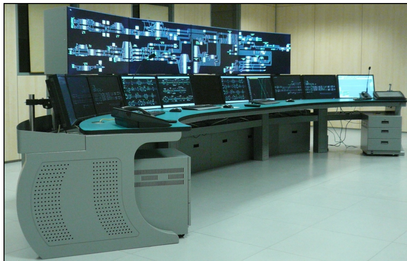
Figura 5 – Esempio di postazione ACCM/SCCM integrata
