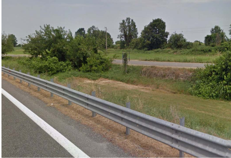
Barriera H2 BL esistente in corrispondenza dell'innesto della variante a sud di Casalpusterlengo
