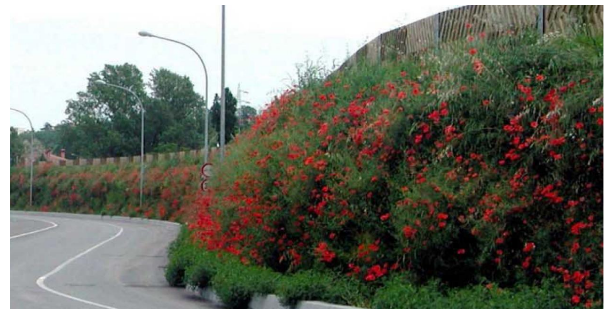
Duna antirumore sormontata da barriera acustica
