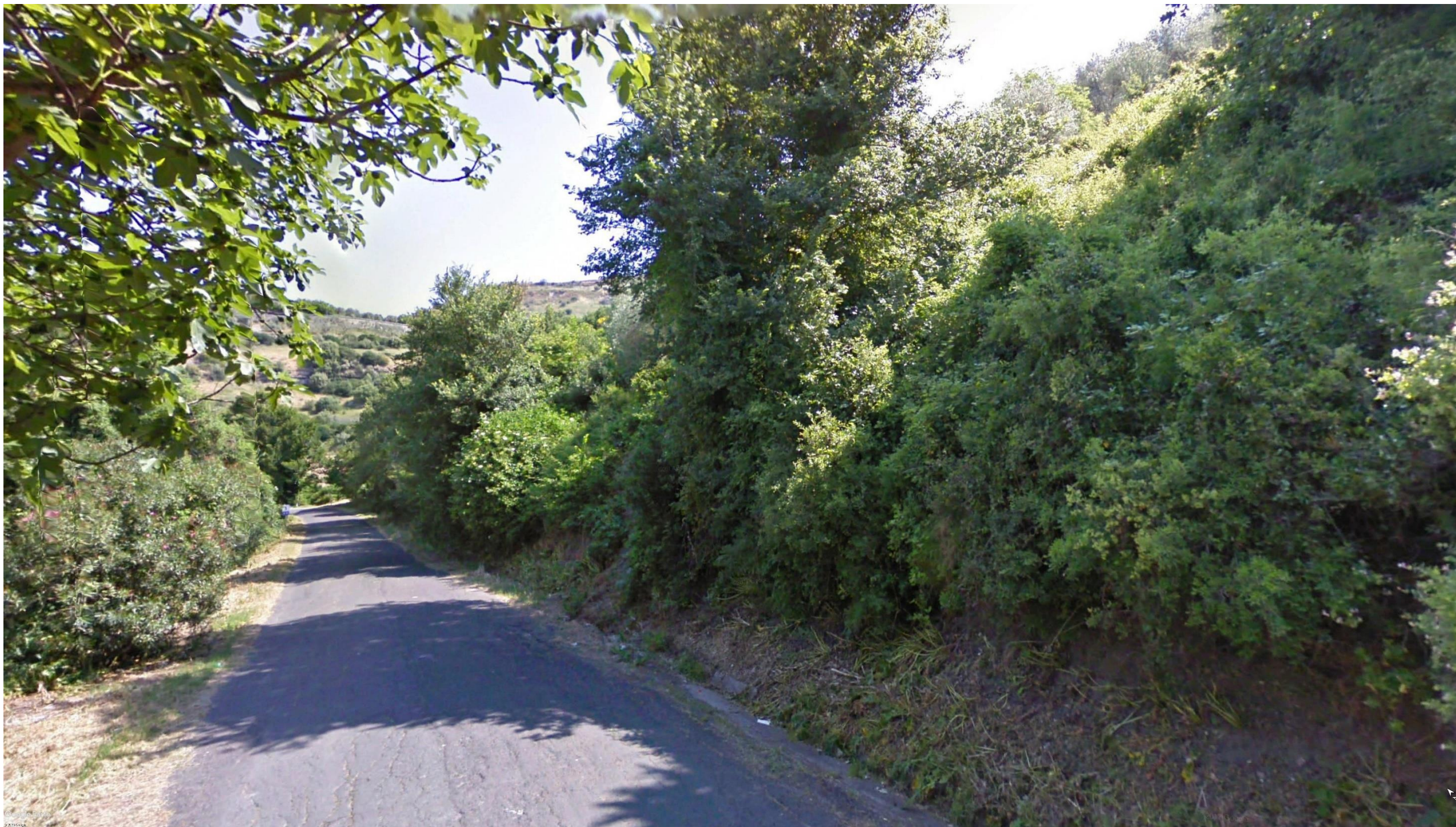
Punto 9: Progressiva 3+100.00. Vista dalla Srada Provinciale 152 in direzione nord. Nell'area inquadrata in foto, risulta visibile l'asse stradale e sulla destra una vegetazione appartenente ad un'area boschiva con presenza di alberature fitte (fonte: Google Earth).
