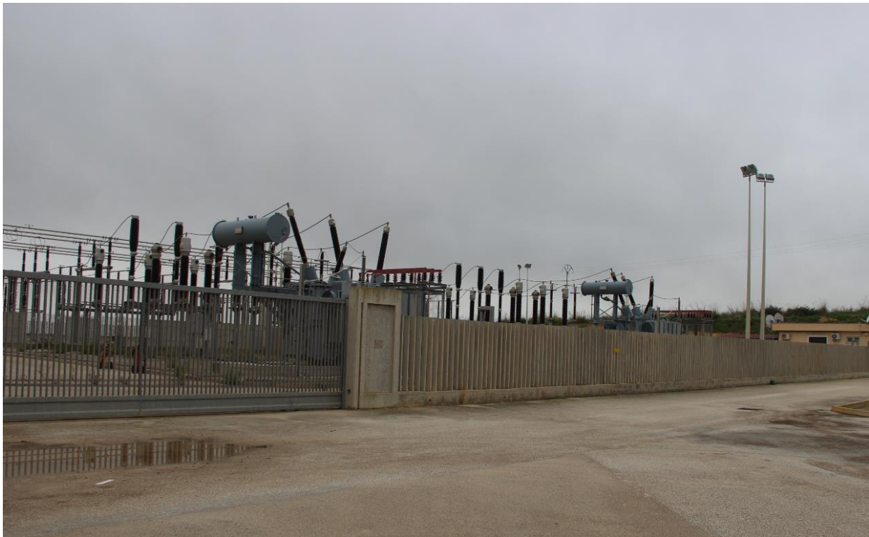
Figura 16– Stazione Elettrica SE RTN “Sambuca” all’interno della quale è prevista la realizzazione dello stallo arrivo cavo AT
