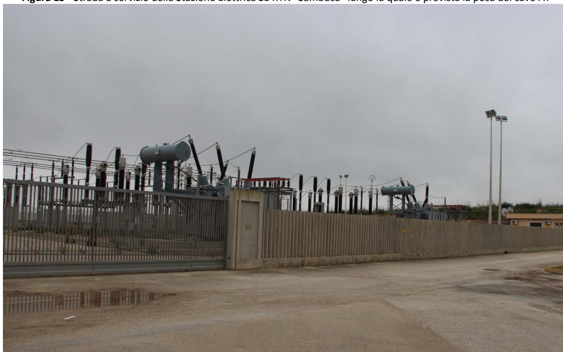
Figura 16 - Stazione Elettrica SE RTN "Sambuca" all'interno della quale è prevista la realizzazione dello stallo arrivo cavo AT
