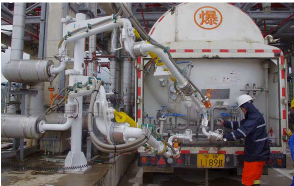
Fig. 8.3 - esempi di bracci di carico per il riempimento delle autocisterne/isocontainer.
