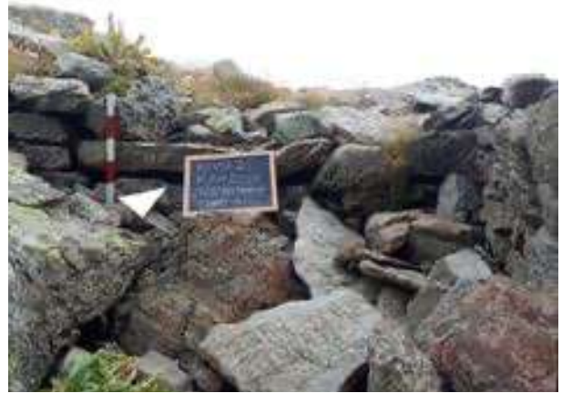
Figura 55. Il crollo che riempie il vano C del corpo A della Casa dei minatori.
