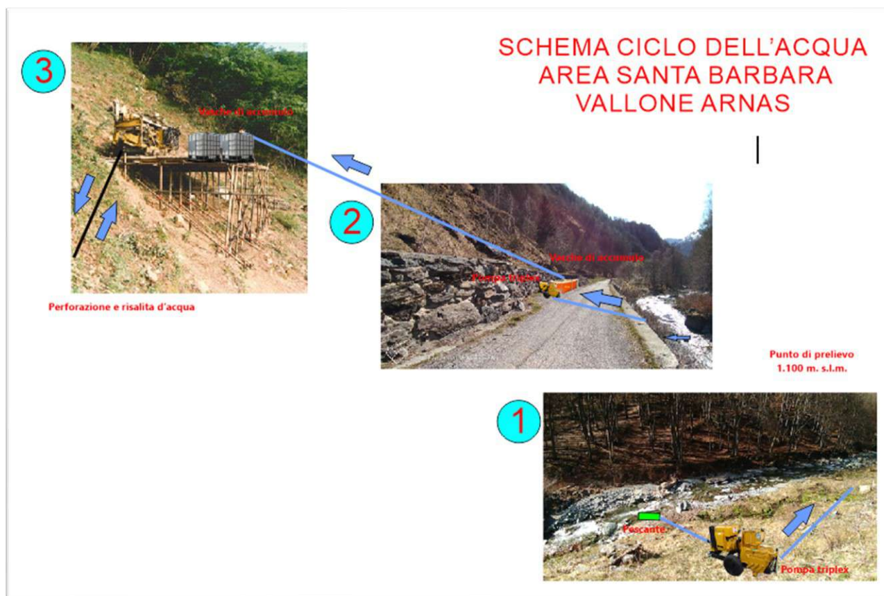
Figura 118- Schema tipologico dell'impianto di fornitura/depurazione delle acque di perforazione area Santa Barbara
