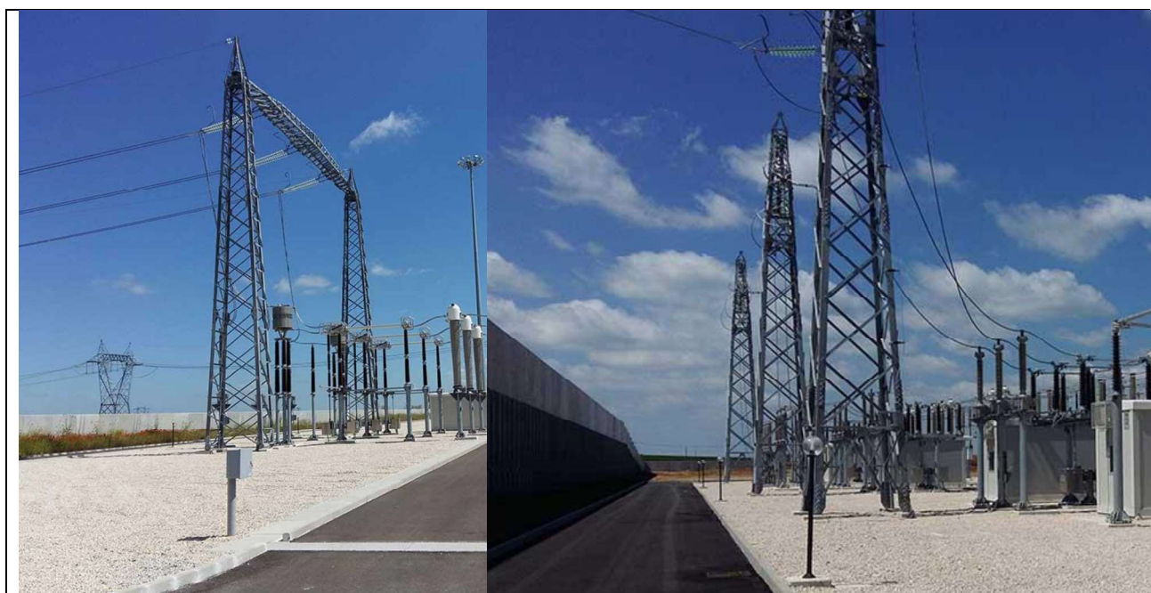
Stazione elettrica Terna di Genzano - Basilicata 380/150 kV di Genzano Basilicata (di recente costruzione)
