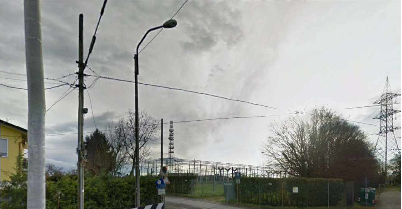
Stazione elettrica di Venezia Nord
