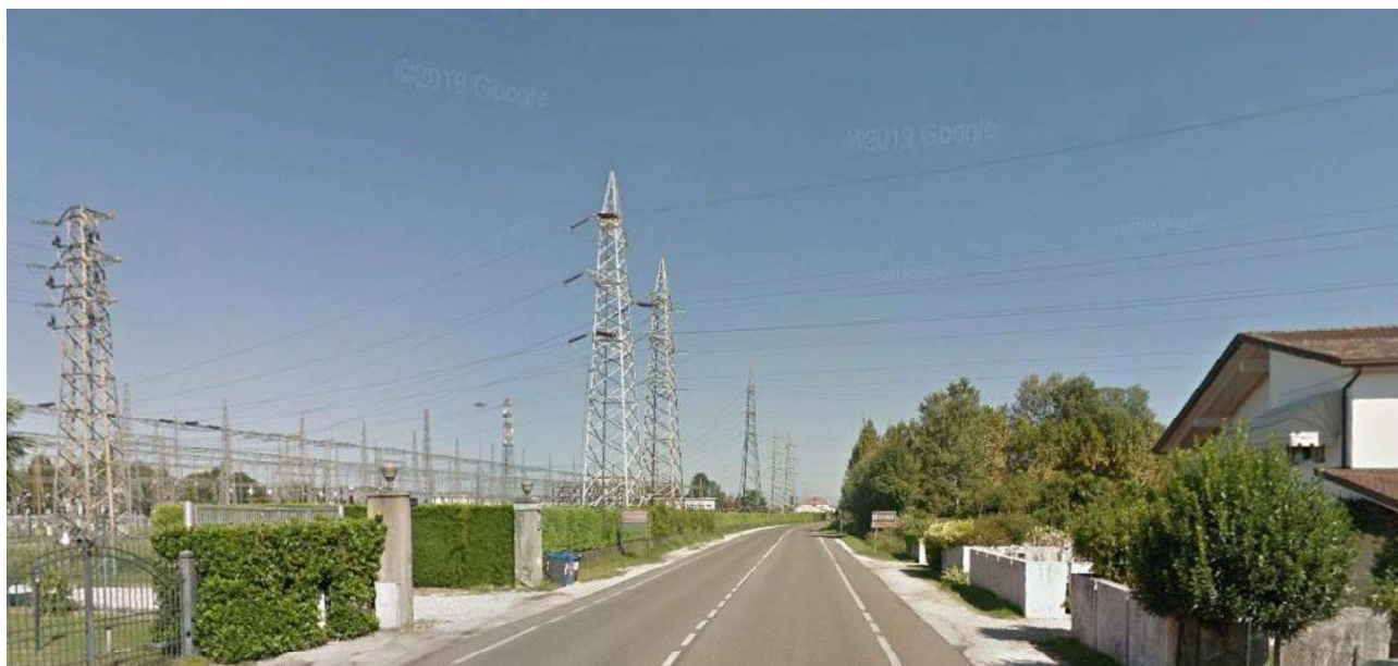
Stazione elettrica di Scorzè (VE)
