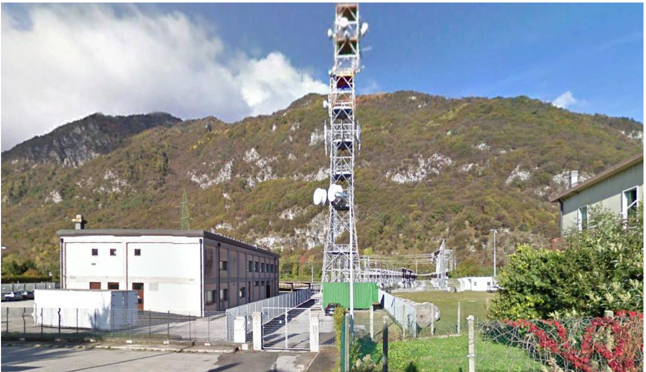
Stazione elettrica di Ponte nelle Alpi (BL)
