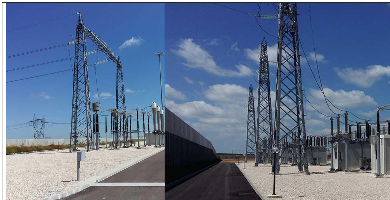
Stazione elettrica Terna di Genzano - Basilicata 380/150 kV di Genzano Basilicata (di recente costruzione)
