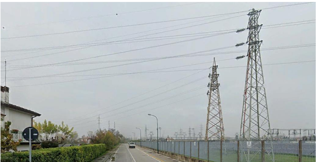
Stazione elettrica di Villa Bona Venezia Mestre
