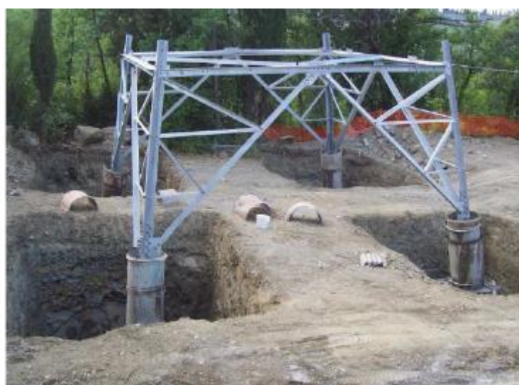
Figura 3-30- Nell'immagine si possono osservare le quattro buche, la base del sostegno collegata alla fondazione tramite i "monconi" ed i casseri utilizzati per i quattro "colonnini"
