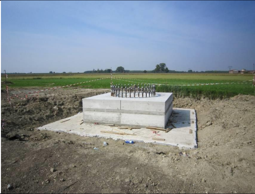
Figura 17 - Realizzazione di fondazioni superficiali tipo plinto a monoblocco per un sostegno monostelo.
