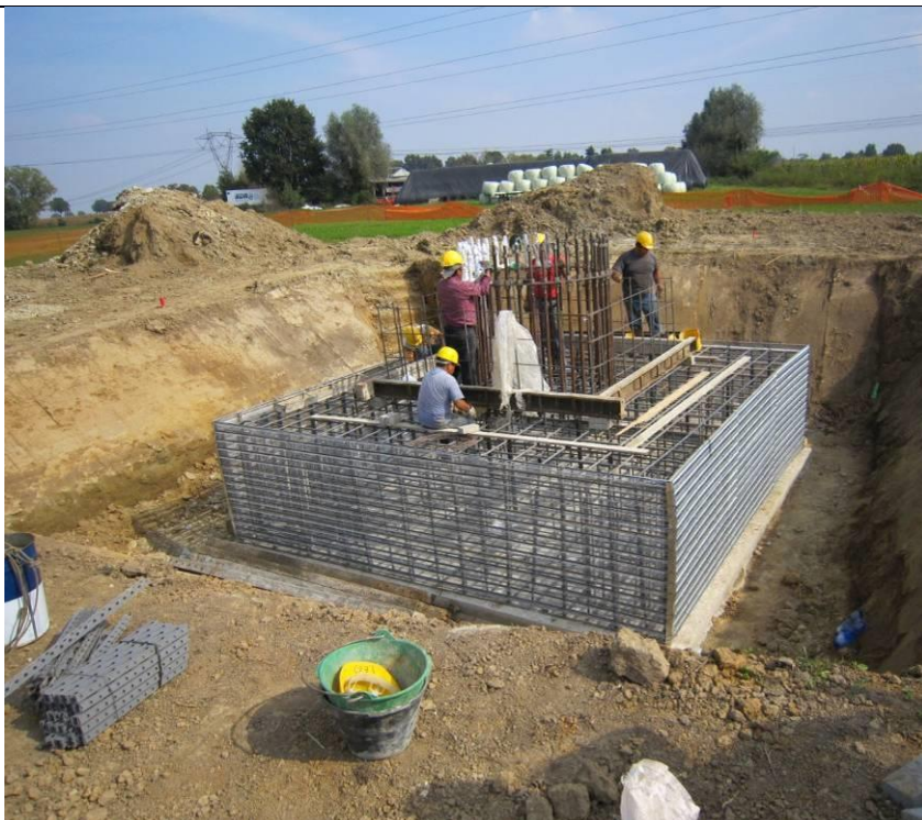
Figura 16 - Realizzazione di fondazione superficiale tipo plinto a monoblocco per un sostegno monostelo.
