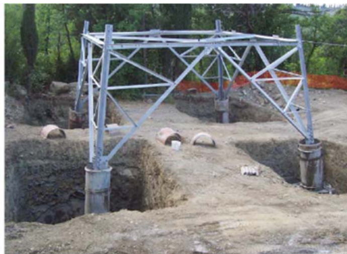
Figura 3-9- Nell'immagine si possono osservare le quattro buche, la base del sostegno collegata alla fondazione tramite i "monconi" ed i casseri utilizzati per i quattro "colonnini"
