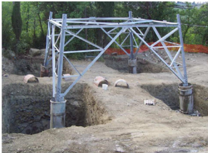
Figura 4-7- Nell'immagine si possono osservare le quattro buche, la base del sostegno collegata alla fondazione tramite i "monconi" ed i casseri utilizzati per i quattro "colonnini"
