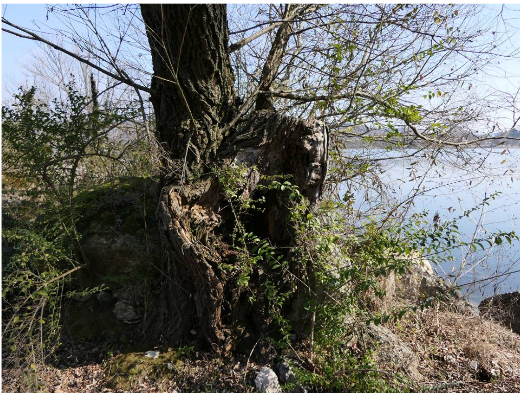
Figura 38: Esempio di albero compromesso dal punto di vista fitosanitario presente lungo la parte ovest della darsena.
