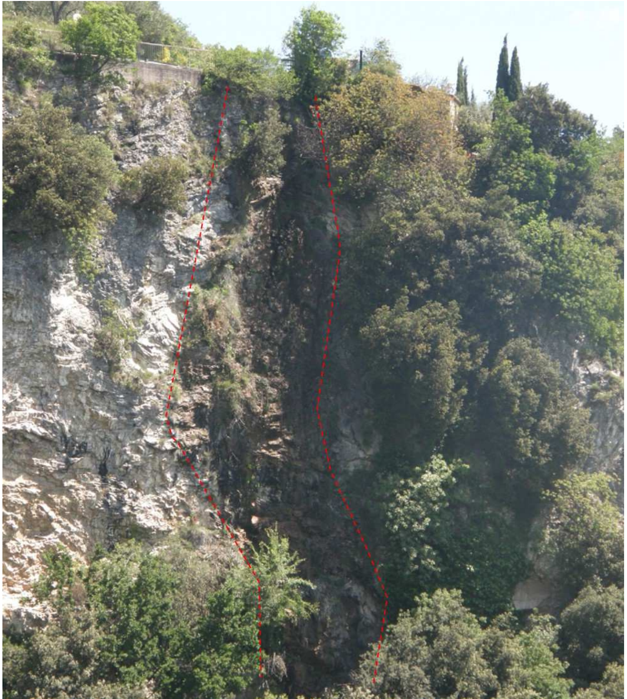
Figura 31 – Porzione settentrionale della parete 1A con evidenziata fra le due linee rosse tratteggiate un settore interessato da stillicidio di acqua che altera il colore superficiale della roccia rendendola color ruggine.
