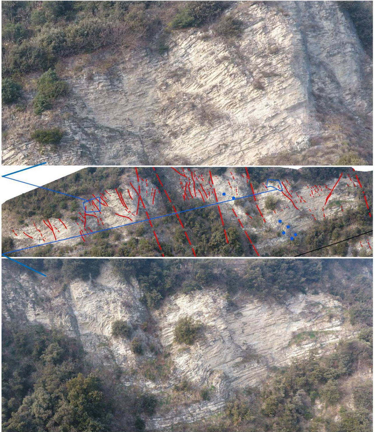
Figura 30 – Al centro panoramica della parete 4A con evidenziati alcuni delle principali e più persistenti discontinuità strutturali. In alto ed in basso alcuni dettagli fotografici che evidenziano l'elevata deformazione a cui è stato soggetto questo settore di parete. Nel dettaglio in basso risaltano una serie di pieghe.
