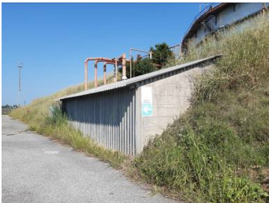
Figura 3-18 - Edificio valvole antincendio bacini
