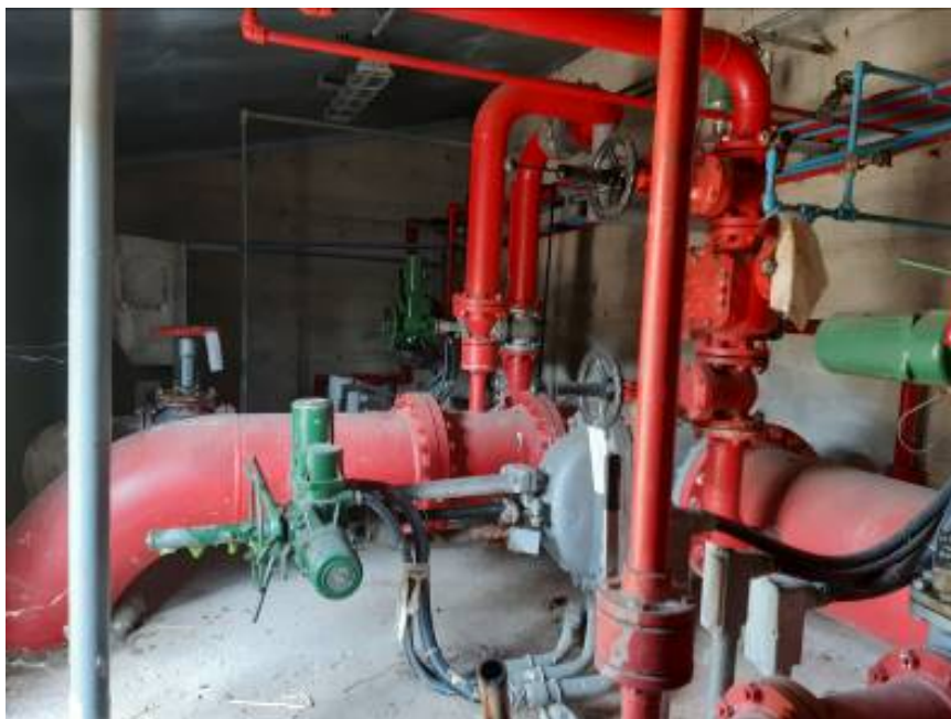
Figura 3-19 - Interno edificio valvole antincendio bacini
