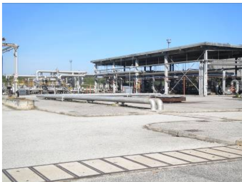
Figura 3-4 Tettoia pompe e riscaldatori PN2
