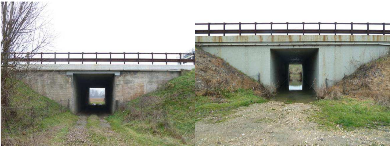
FIGURA 3.4.1-2 – FENOMENI DI RISTAGNO IDRICO NEL SOTTOVIA AGRICOLI: INTERVENTO 05 (SINISTRA), INTERVENTO 08 (DESTRA)
